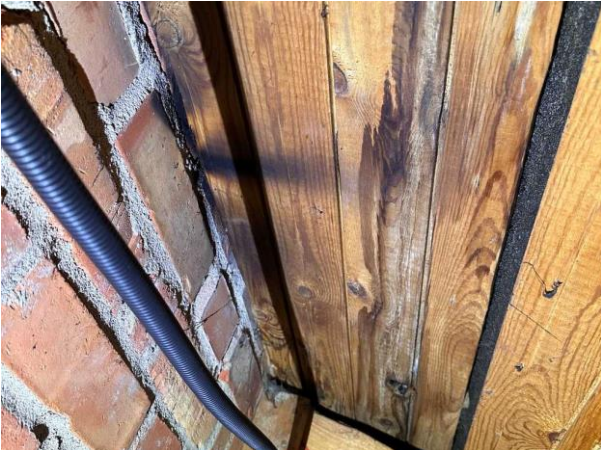
Bild 3: Utvändigt, Vind, Missfärgningar spår av äldre läckage noterades på del av underlagstaket (torrt vid besiktningen) Huset är självdragsventilerat och del av vi...
