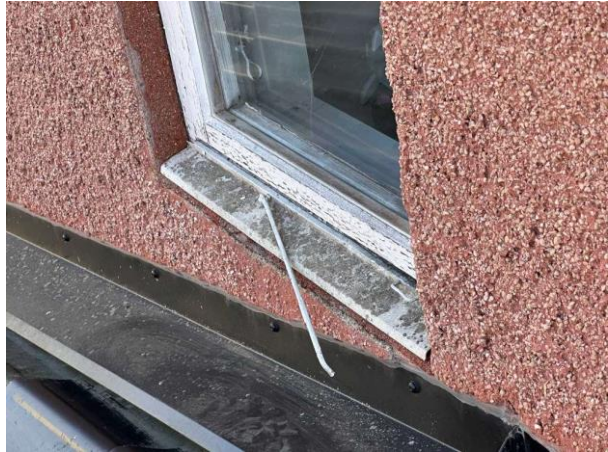
Bild 2: Utvändigt, Fönster, Äldre fönster färgsläpp noterades altandörren är i behov av byte För kort fönsterbleck noterades på gavelfönster övre plan
