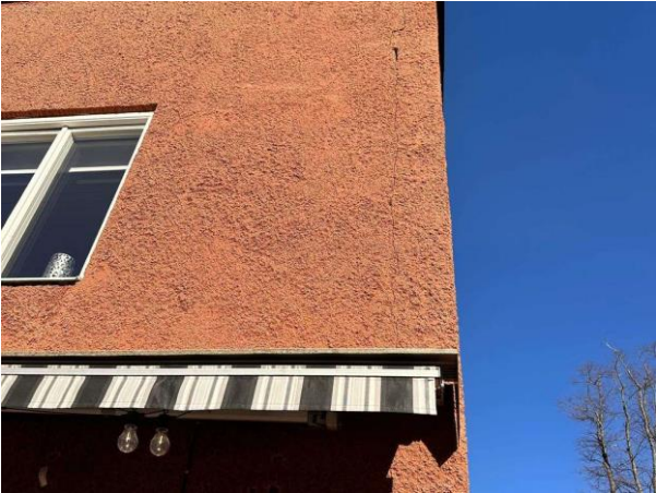
Bild 1: Utvändigt, Fasad, Rörelsespricka i fasaden på baksidan Lokalt lös puts, det förekommer flera äldre lagningar i fasaden, fasaden bör på sikt repareras och puts...
