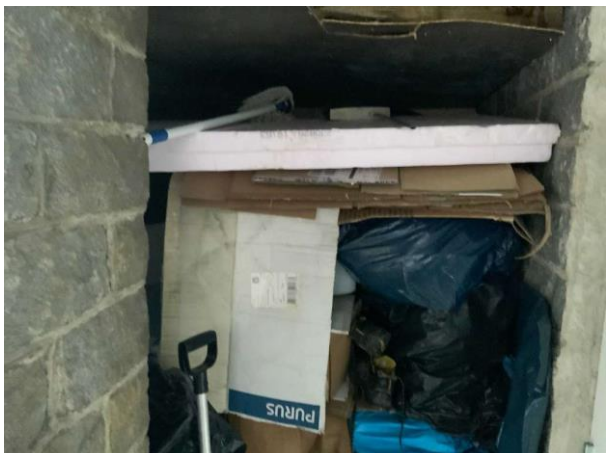
Bild 6: Utvändigt, Övrigt, Utrymme under altan är belamrat .
