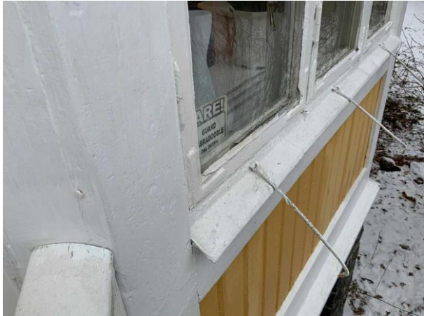
Bild 4: Utvändigt, Fönster, Färg och kittsläpp noterades
