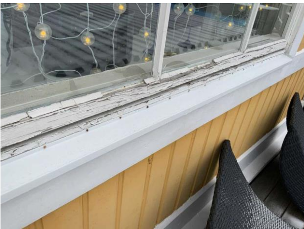
Bild 5: Utvändigt, Fönster, Färg och kittsläpp noterades
