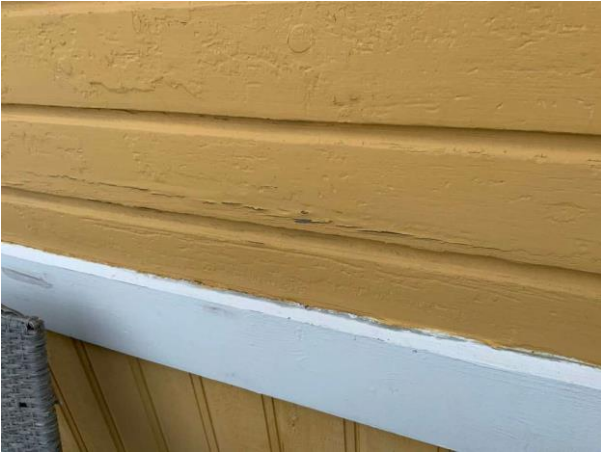
Bild 1: Utvändigt, Fasad, Sprickor noterades på fasadpanelen
