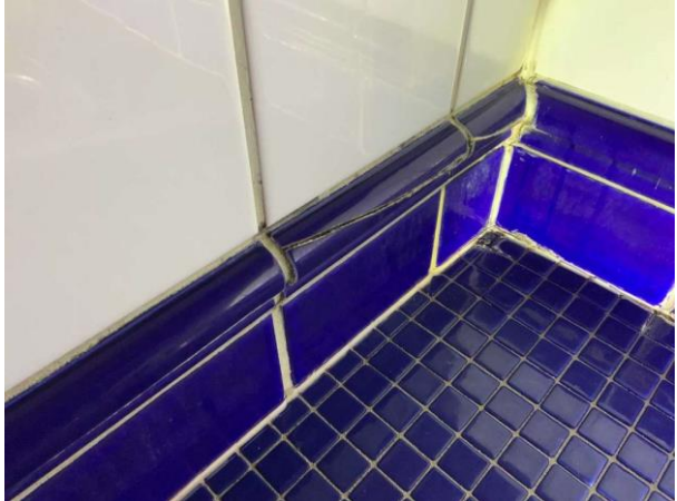
Bild 14: Invändigt, Övervåning, Badrum, Sprickor i kakel
