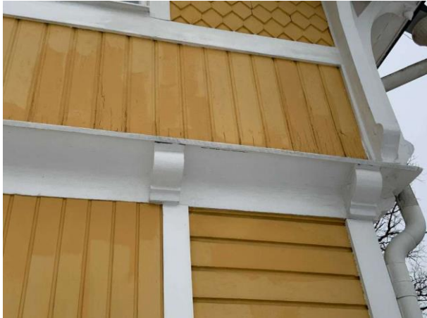
Bild 2: Utvändigt, Fasad, Sprickor
