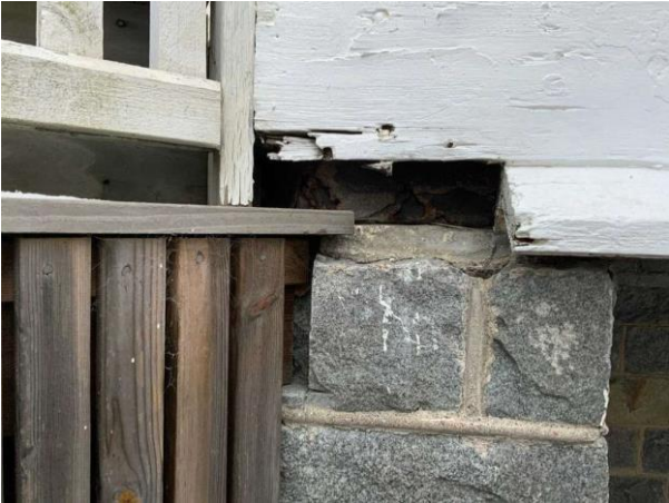
Bild 3: Utvändigt, Fasad, Del av offerbräda saknas vid burspråk
