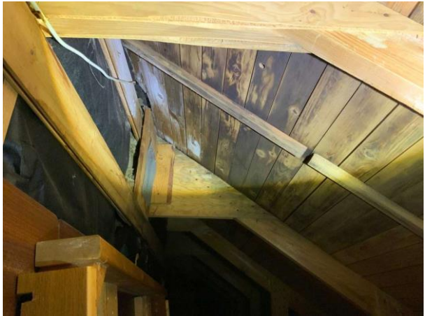
Bild 10: Invändigt, Övervåning, Kattvind 1, Mikrobiell påväxt noterades på underlagstaket Luftningen mot underlagstaket är igensatt Äldre läckage vid takfönster Frost på underlagstaket...
