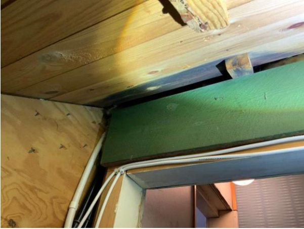
Bild 7: Invändigt, Övervåning, Kattvind 1, Mikrobiell påväxt noterades på underlagstaket Luftningen mot underlagstaket är igensatt Se riskanalys vind
