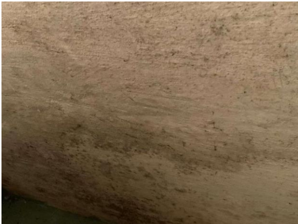
Bild 1: Invändigt, Källarplan, Hall, Missfärgningar mikrobiell påväxt noterades lokalt på källarväggar och under bjälklag Utrymme under trapp är inbyggt (ej besiktat)
