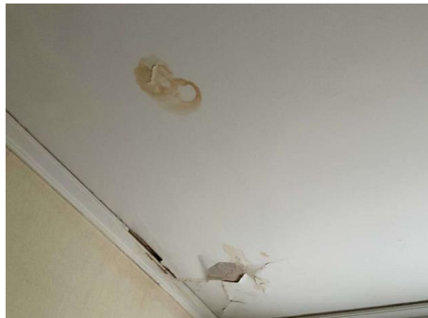
Bild 4: Invändigt, Entréplan, Entréhall, Fuktläckar i tak noterades (torrt vid besiktning) Bubblor lös väv på vägg
