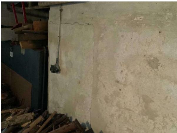
Bild 3: Invändigt, Källarplan, Pannrum, Åldre Gjutjärnsbrunn noterades Sprickor i källarväggar noterades
