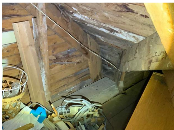
Bild 7: Invändigt, Inredd vind, Kattvind 2, Spår av träskadeinsekter på råspont Mikrobiell påväxt noterades lokalt samt små spår av genomträngande vatten
