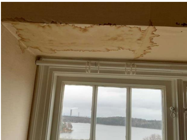
Bild 5: Invändigt, Övervåning, Sovrum 2, Trasigt vävtak Fuktläck/missfärgning i tak vid burspråk (torr vid besiktning)
