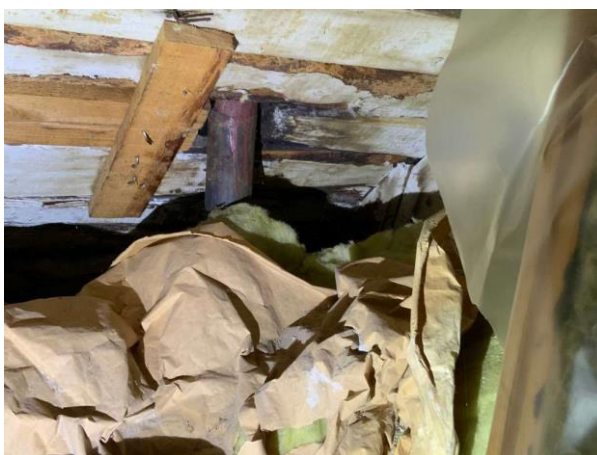
Bild 8: Invändigt, Inredd vind, Kattvind 3, Missfärgningar mikrobiell påväxt noterades lokalt på råspont Spår av fukt runt genomföring i tak
