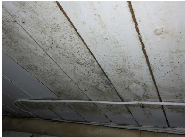
Bild 2: Invändigt, Källarplan, Hall, Missfärgningar mikrobiell påväxt noterades lokalt på källarväggar och under bjälklag Utrymme under trapp är inbyggt (ej besiktat)
