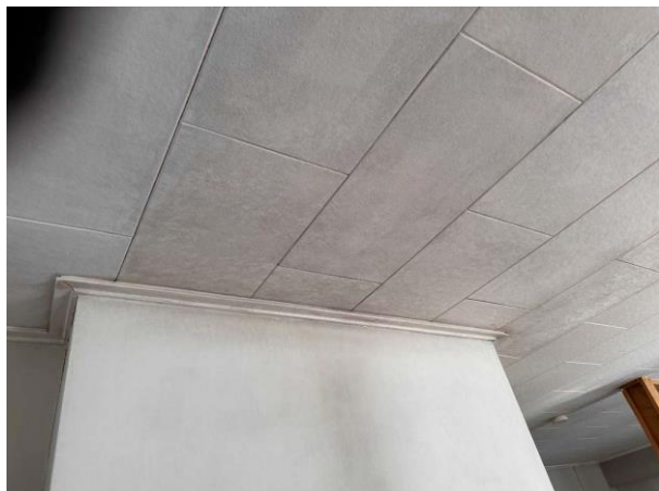
Bild 7: Invändigt, Övre plan, Vardagsrum/hall, Fuktmärke på golv under radiator Spår av äldre läckage i tak vid murstock (se säljarens upplysningar) Mindre spricka i puts öppenspis
