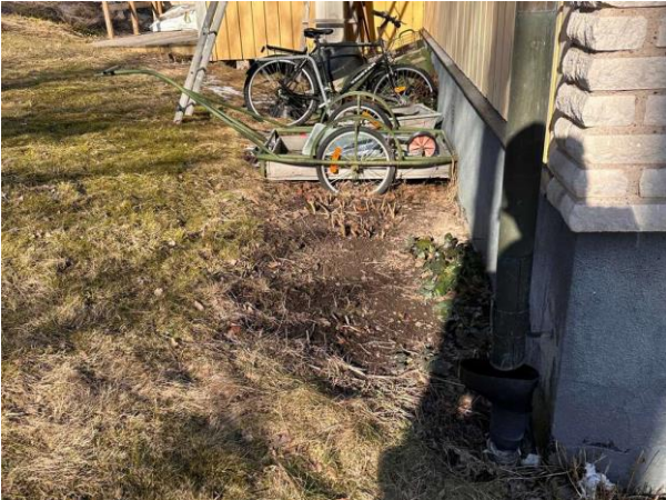
Bild 1: Utvändigt, Mark, Delvis äldre dränering Se riskanalysen Marken lutar delvis mot huset Det förekommer fukthållande rabatter och träd mot husgrunden
