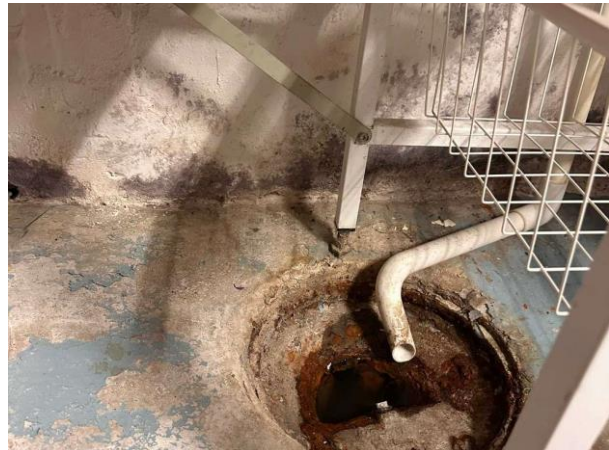
Bild 4: Invändigt, Souterrängplan, Pannrum/tvättstuga, Äldre standard Gjutjärnsbrunn (byt vid renovering) Fuktgenomslag noterades på källarväggarna
