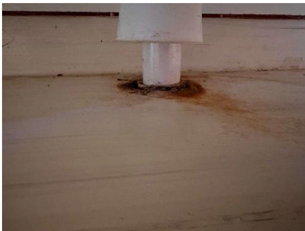
Bild 8: Invändigt, Övre plan, Duschrum, Äldre våtrum med renoveringsbehov Äldre gjutjärnsbrunn (byt vid renovering) Avlopp under handfat sticker inte upp ur golv Ej tätt runt avl...
