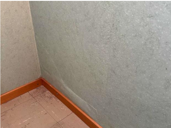
Bild 3: Invändigt, Souterrängplan, Sovrum 1, Hörn mot bastun har putsen släppts bakom tapeten
