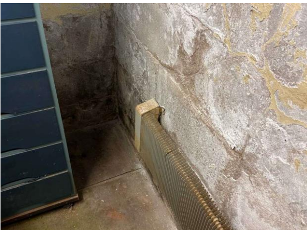
Bild 5: Invändigt, Souterrängplan, Förråd, Fuktgenomslag och putssläpp noterades på grundmurens nedre del i vägghörn
