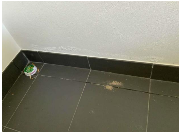
Bild 6: Invändigt, Källarplan, Gästrum, Lös klinkerrad mot vägg/sättning Fuktuppsugning noterad i källarväggens nedre kant Se fortsatt teknisk utredning
