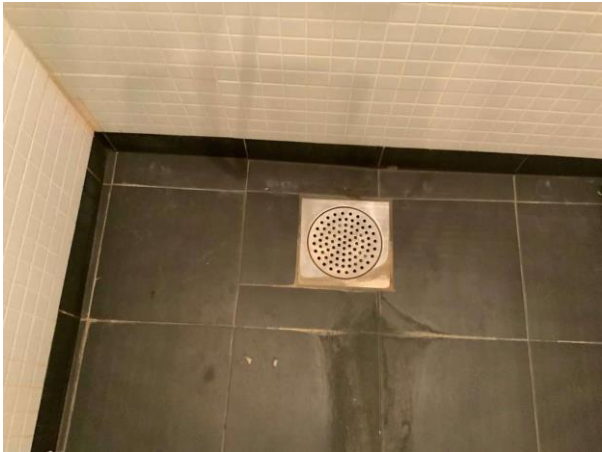
Bild 7: Invändigt, Källarplan, Duschrum, Golvbrunnen är väggnära placerad Brunnsduken är synlig under klämringen (ej korrekt tillskuren)
