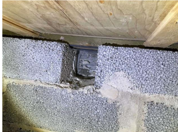
Bild 2: Utvändigt, Krypgrund, Tryckimpregnerad syll noterades (kan avge kemisk lukt vid instängda miljöer) Mindre blånad noterades lokalt på blindbottens undersida Se ris...
