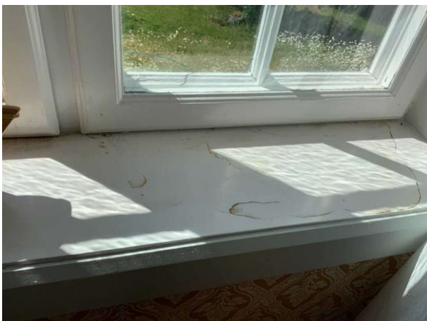
Bild 11: Invändigt, Entréplan, Bibliotek/matsal, Spår av inträngande vatten/fukt vid fönster
