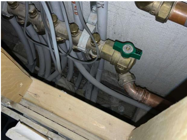
Bild 9: Invändigt, Entréplan, Duschrum, Inbyggnad för golvvärmen saknar bakomliggande tätskikt Sättbruk och tätskikt draget över Klämring Klämring glipar mot golvbrunnens säte Kval...
