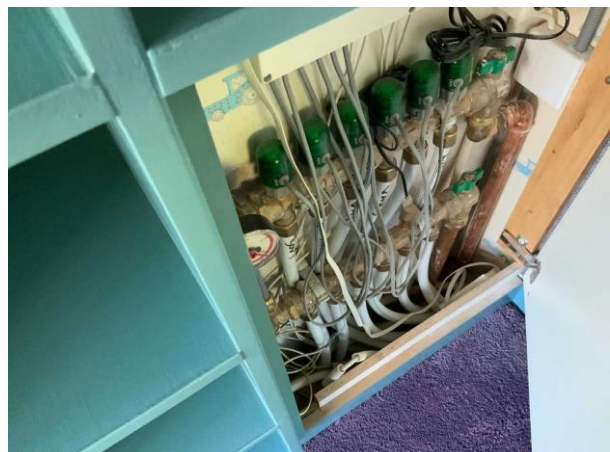
Bild 12: Invändigt, Övervåning, Sovrum 1, Inbyggnad för vattenkopplingar saknar bakomliggande tätskikt
