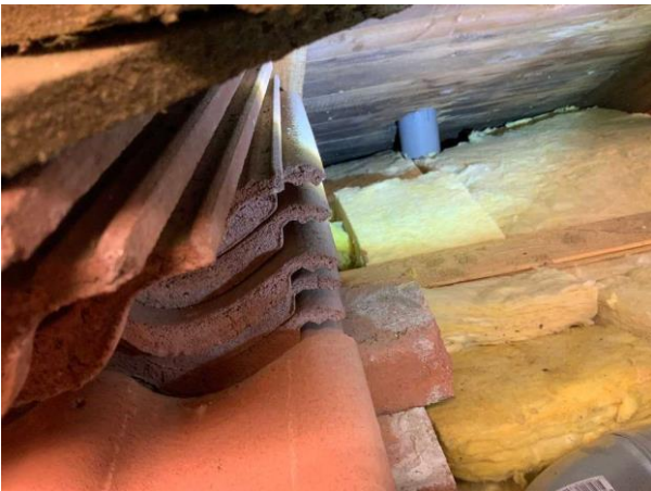
Bild 5: Utvändigt, Vind, Lucka saknas till vind tillbyggnad Äldre spår av träskadeinsekter (kontrollerat av Anticimex) Lokalt noterades mikrobiell påväxt på underlag...
