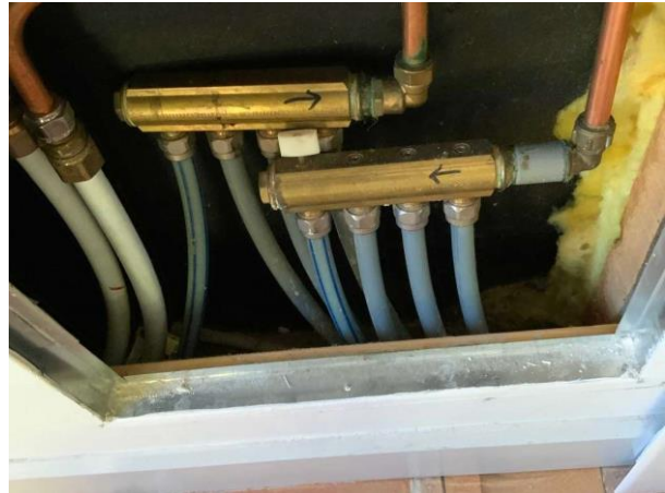
Bild 8: Invändigt, Entréplan, Entréhall, Skada klinkergolv noterades Inbyggnad golvvärmen saknar tätskikt
