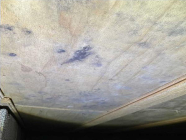
Bild 1: Utvändigt, Krypgrund, Tryckimpregnerad syll noterades (kan avge kemisk lukt vid instängda miljöer) Mindre blånad noterades lokalt på blindbottens undersida Se ris...
