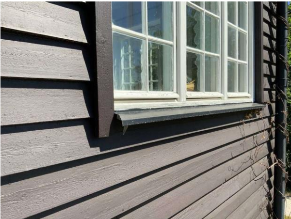
Bild 3: Utvändigt, Fönster, Uppvik saknas på några fönsterbleck Färgsläpp noterades på karmar
