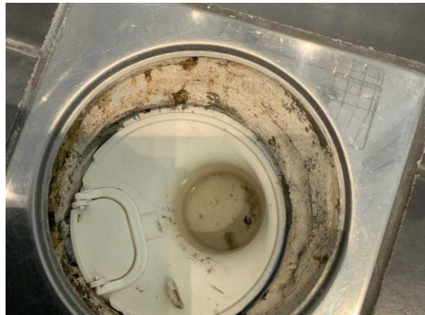
Bild 10: Invändigt, Entréplan, Duschrum, Inbyggnad för golvvärmen saknar bakomliggande tätskikt Sättbruk och tätskikt draget över Klämring Klämring glipar mot golvbrunnens säte Kval...
