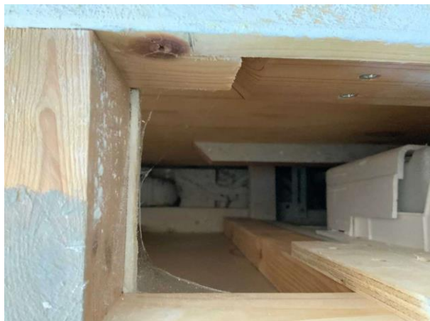
Bild 13: Invändigt, Övervåning, Badrum, Inbyggnad spolcistern för toalett saknar bakomliggande tätskikt och Skvallerrör Krackeleringar i handfat Helkaklat, tätskikt under kakel och...
