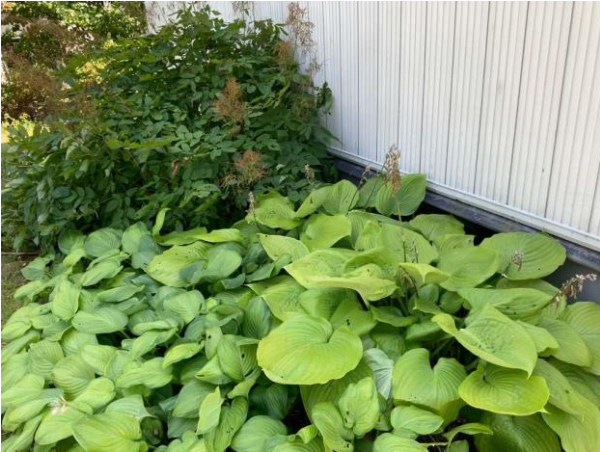
Bild 1: Utvändigt, Mark, Fukthållande rabatter och växter mot husgrunden. Äldre dränering med sk elephantmatta
