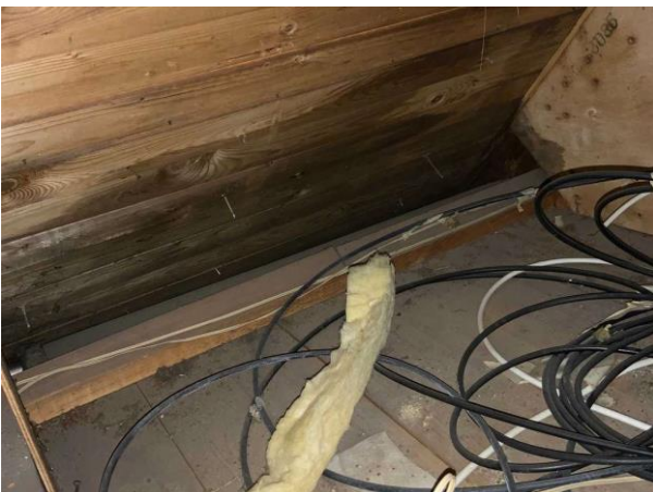
Bild 5: Invändigt, Övervåning, Kattvind 1, Spår av kondens vid takfot
