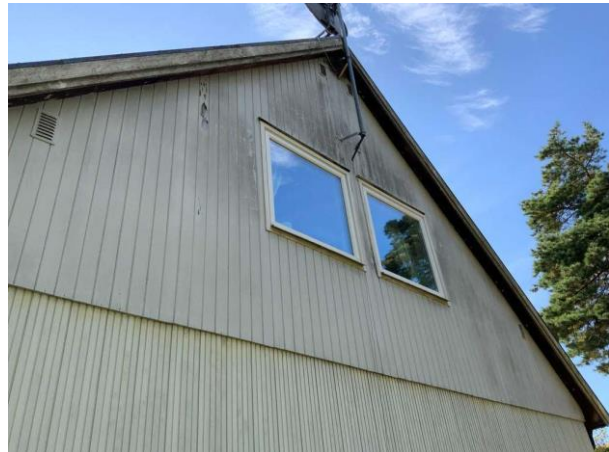
Bild 4: Utvändigt, Fasad, Missfärgningar på fasad noterades Färgsläpp noterades på fasadpanel
