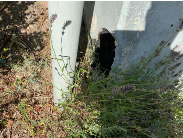
Bild 3: Utvändigt, Grundmur/Hussockel, Färgsläpp noterades på grundmur Topplist lös på del av grundmur Putsläpp noterades på grundmur
