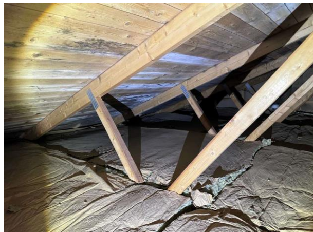
Bild 6: Invändigt, Övervåning, Nockvind, Huset är självdragsventilerat se riskanalysen Del av vinden är parallellisolerad Mikrobiell påväxt noterades på underlagstaket Fuktbläck på...
