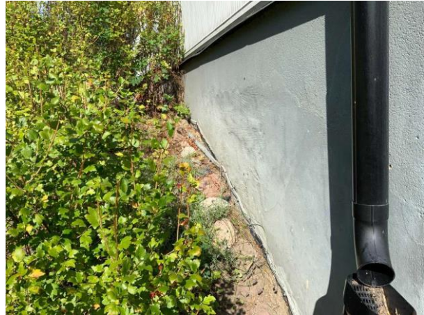
Bild 2: Utvändigt, Grundmur/Hussockel, Färgsläpp noterades på grundmur Topplist lös på del av grundmur Putsläpp noterades på grundmur
