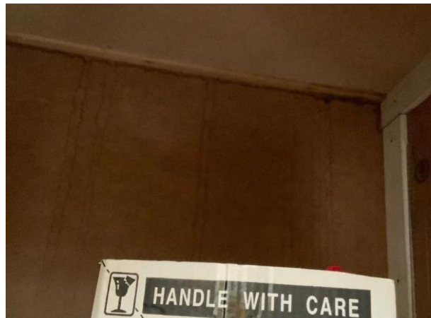
Bild 6: Invändigt, Entréplan, Sovrum 1, Köldbryggor noterades i takvinkel Äldre rinning noterades i garderob
