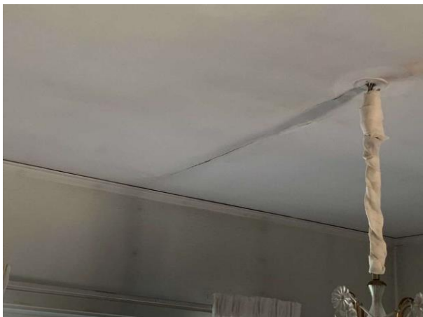
Bild 7: Invändigt, Entréplan, Matrumsdel, Spricka noterades i vävtak
