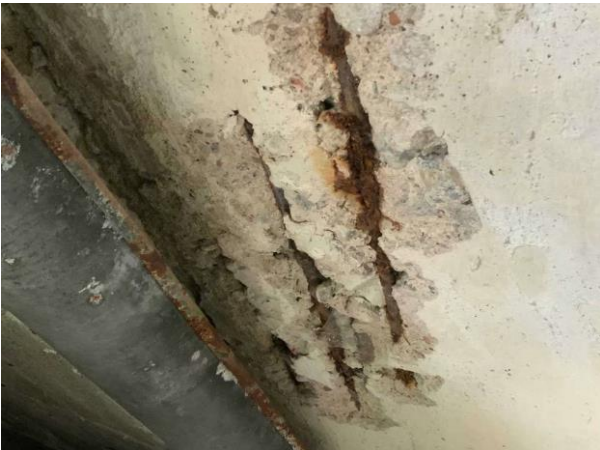
Bild 3: Utvändigt, Altan, Betongbjälklaget är skadat och armering är synlig (rostig) Putssläpp noterades på väggar
