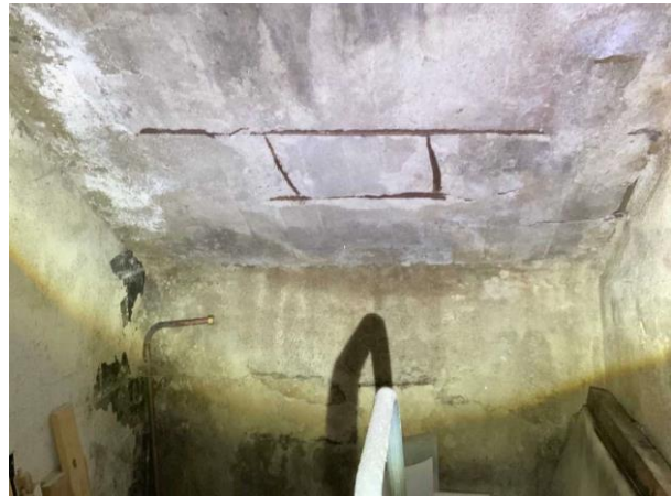
Bild 4: Utvändigt, Altan, Betongbjälklaget är skadat och armering är synlig (rostig) Putssläpp noterades på väggar
