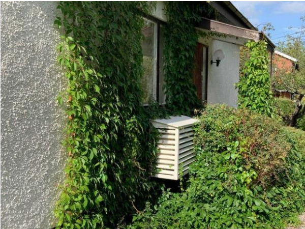
Bild 1: Utvändigt, Fasad, Klängväxter mot fasad (fukthållande samt döljer del av fasad) Lokalt saknas puts och träullsskivor är synliga
