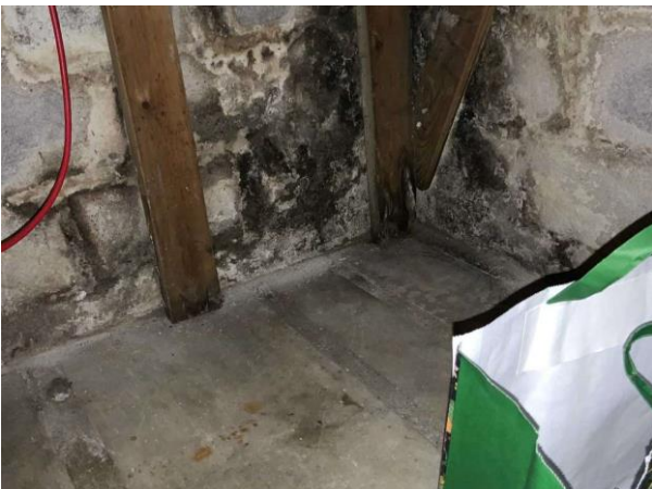
Bild 5: Invändigt, Souterrängplan, Hobbyrum, Fuktgenomslag noterades på grundmur missfärgning/mikrobiell påväxt
