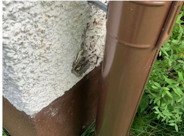
Bild 2: Utvändigt, Fasad, Klängväxter mot fasad (fukthållande samt döljer del av fasad) Lokalt saknas puts och träullsskivor är synliga
