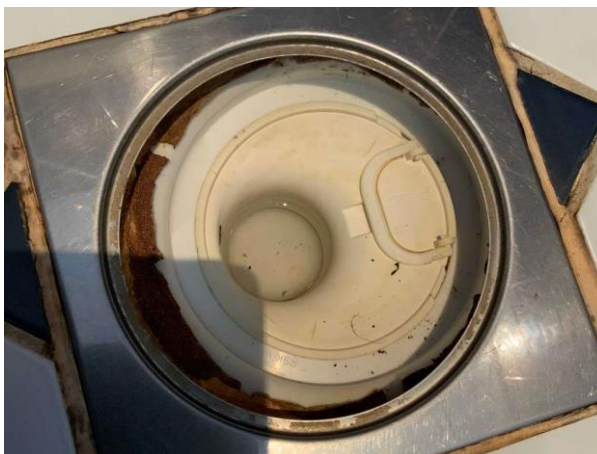
Bild 4: Invändigt, Entréplan, Duschrum, Äldre våtrum med renoveringsbehov Kommod är lös Klämring saknas i golvbrunnen Mjukfog runt golvbrunnen Se riskanalysen Helkaklat, tätskik...
