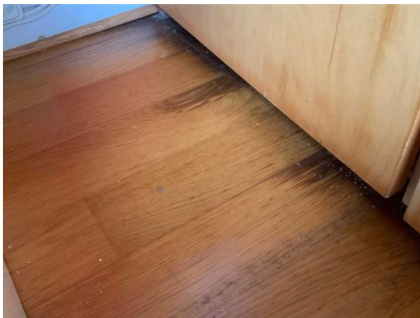
Bild 2: Invändigt, Souterrängplan, Hall, Missfärgningar fuktskador i trägolv se fortsatt teknisk utredning Golv sviktar/lutar
