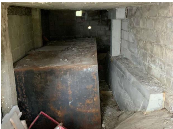
Bild 1: Utvändigt, Utrymme under altantrappa, Oljetank finns kvar Rostig armering synlig i bjälklaget
