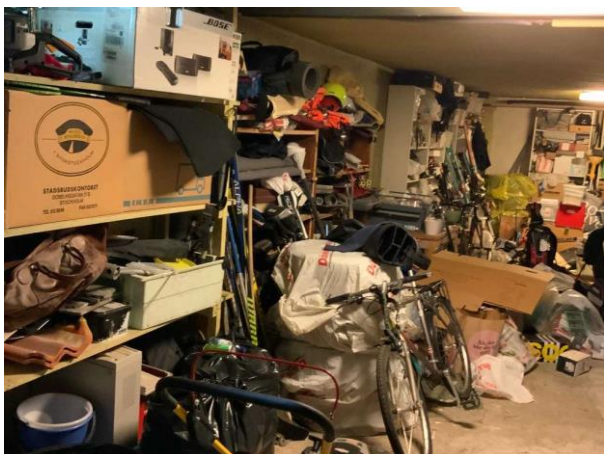
Bild 3: Invändigt, Souterrängplan, Garage, Belamrat runt ytterväggar begränsat besiktat Äldre golvbrunn av gjutjärn
