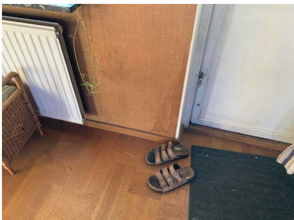
Bild 29: Invändigt, Entréplan, Matrum, Fuktfläck på vägg vid balkongdörr
