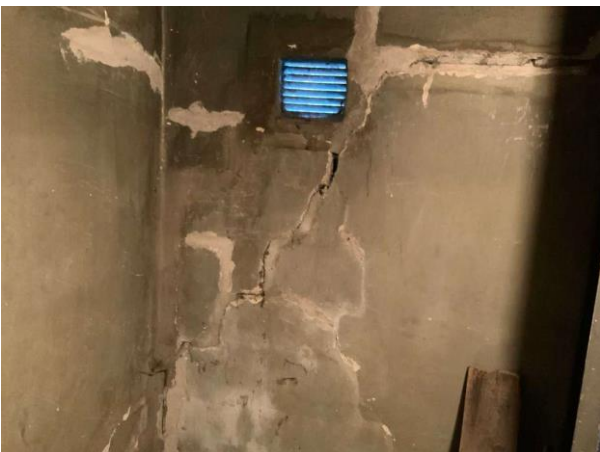
Bild 11: Invändigt, Källarplan, Allmänt, Kraftiga Sprickor i golv och grundmurar och bjälklag förekommer
