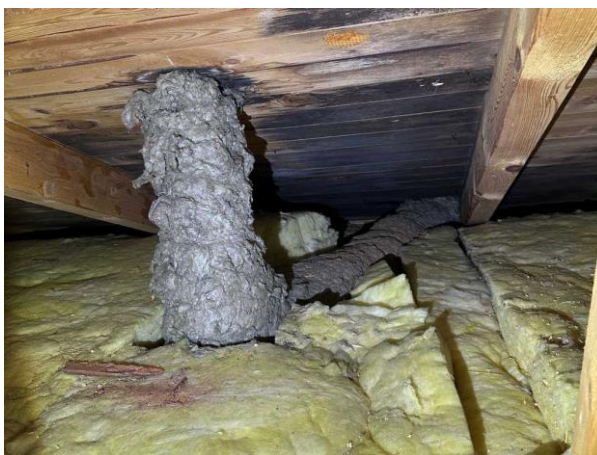
Bild 6: Utvändigt, Vind, Huset är självdragsventilerat se riskanalysen Vinden är tilläggsisolerad Spår av läckage noterades vid ett takstolsfack Spår av kondens mi...
