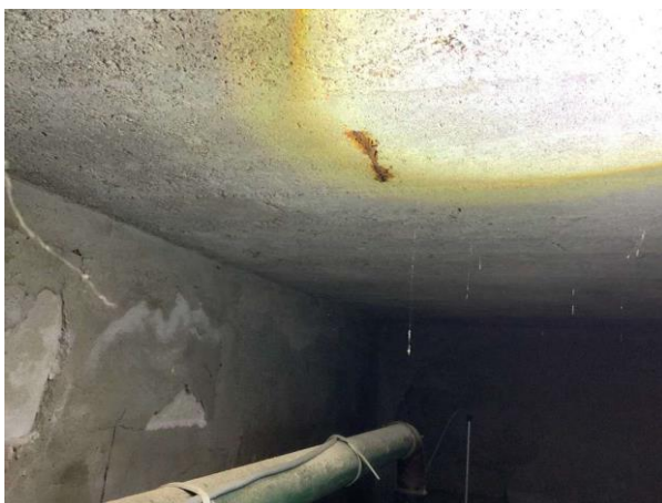
Bild 16: Invändigt, Källarplan, Allmänt, Kraftiga Sprickor i golv och grundmurar och bjälklag förekommer
