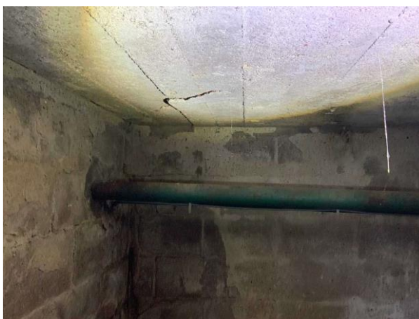
Bild 14: Invändigt, Källarplan, Allmänt, Kraftiga Sprickor i golv och grundmurar och bjälklag förekommer
