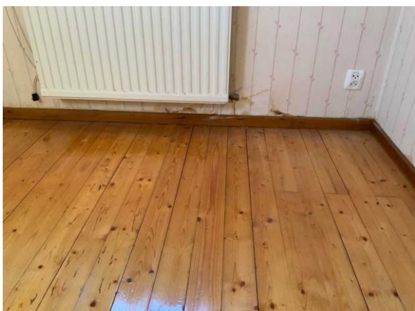
Bild 21: Invändigt, Källarplan, Gillestuga + sovrum, Uppbyggda golv med fuktskador samt fuktfläckar på tapeter se fortsatt teknisk utredning
