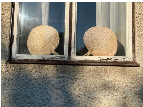
Bild 3: Utvändigt, Fönster, Renoveringsbehov föreligger
