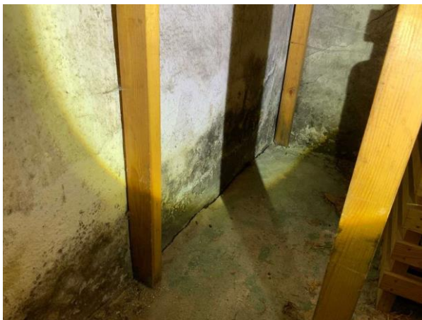
Bild 26: Invändigt, Källarplan, Matkällare, Sprickor och Fuktgenomslag samt mikrobiell påväxt på källarväggar
