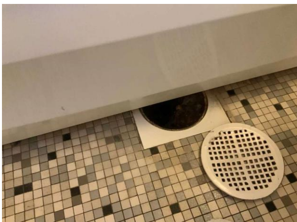
Bild 23: Invändigt, Källarplan, Badrum, Äldre våtrum med renoveringsbehov Golvbrunn av gjutjärn Rostiga trasiga stammar av gjutjärn
