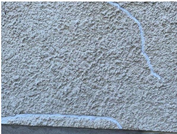
Bild 2: Utvändigt, Fasad, Sprickor samt lagade sprickor noterades
