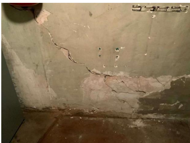
Bild 13: Invändigt, Källarplan, Allmänt, Kraftiga Sprickor i golv och grundmurar och bjälklag förekommer
