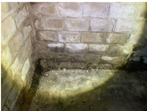
Bild 15: Invändigt, Källarplan, Allmänt, Kraftiga Sprickor i golv och grundmurar och bjälklag förekommer
