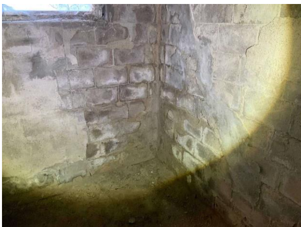
Bild 17: Invändigt, Källarplan, Allmänt, Kraftiga Sprickor i golv och grundmurar och bjälklag förekommer
