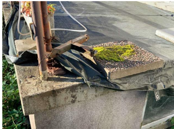
Bild 10: Utvändigt, Övrigt, Altan av betong i behov av renovering
