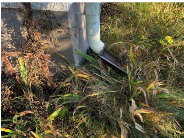
Bild 5: Utvändigt, Avvattning, Avslutas vid husgrunden bör ledas från hus
