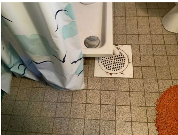
Bild 24: Invändigt, Källarplan, Duschrum, Äldre standard med renoveringsbehov Gjutjärnsbrunn med rost
