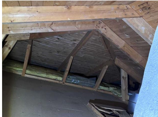
Bild 8: Utvändigt, Vind, Huset är självdragsventilerat se riskanalysen Vinden är tilläggsisolerad Spår av läckage noterades vid ett takstolsfack Spår av kondens mi...
