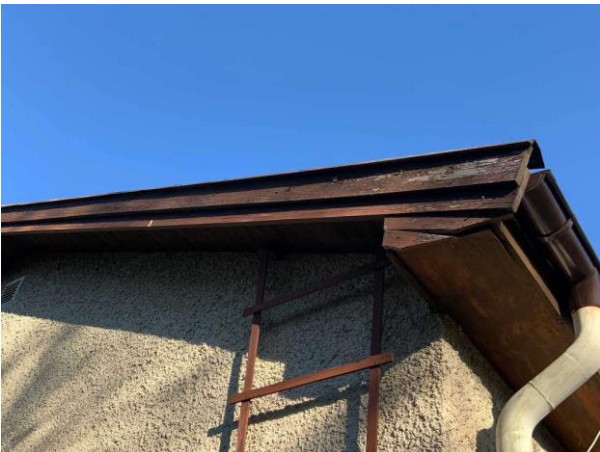
Bild 9: Utvändigt, Yttertak, Äldre tak se riskanalysen Taket är besiktat från takfot pga frost på takpannor Några takpannor ur läge
