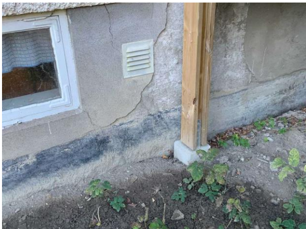
Bild 1: Utvändigt, Grundmur/Hussockel, Sprickor och lös puts noterades
