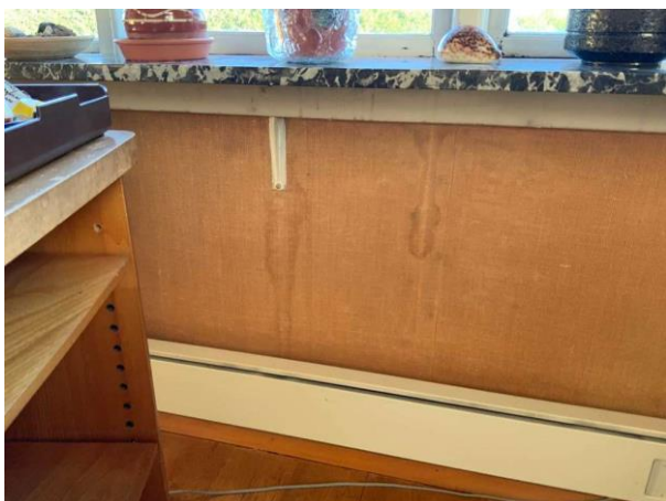
Bild 27: Invändigt, Entréplan, Vardagsrum, Fuktfläckar under fönster
