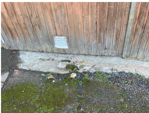
Bild 4: Utvändigt, Ytterdörr, Garagedörr har rötskador i nedre kant Färgsläpp på altandörr
