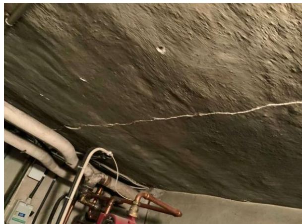
Bild 12: Invändigt, Källarplan, Allmänt, Kraftiga Sprickor i golv och grundmurar och bjälklag förekommer
