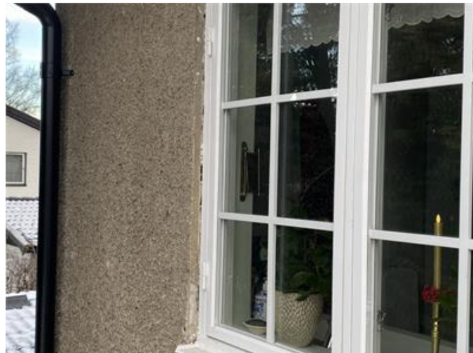
Bild visar otätheter mellan fönsterkarm och vägg.
