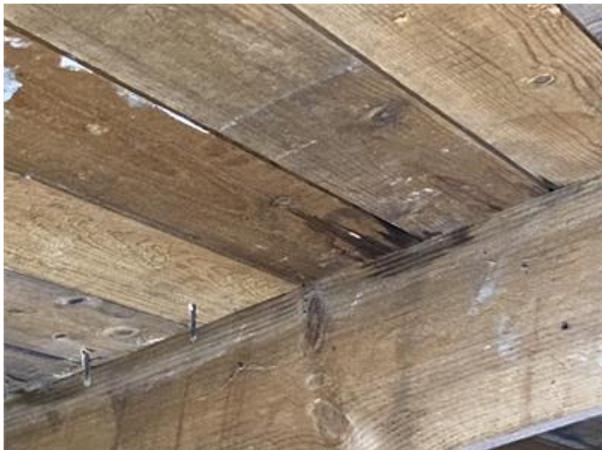
Bild visar fuktfläck där höga fuktvärden erhöles.
