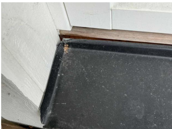
Bild 3: Utvändigt, Ytterdörr, Tröskelplåten är lös vid dörren från köksdelen
