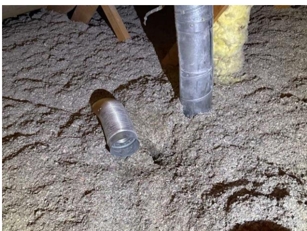
Bild 5: Utvändigt, Vind, Luftningen till avloppet är inte ihopkopplat med genomföringen i taket (ska kopplas ihop) Köksfläkten avslutas på vinden (ska dras ut genom...)
