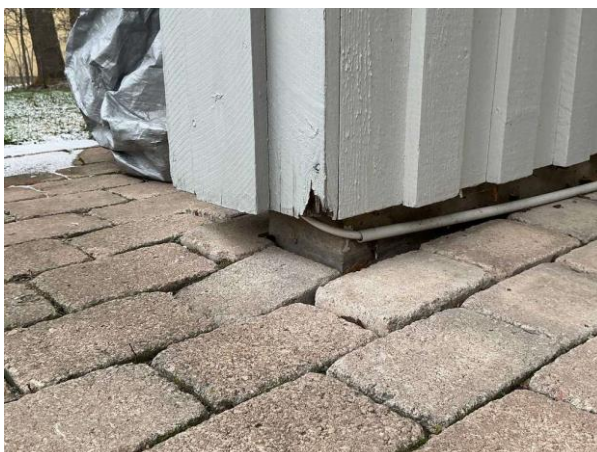
Bild 2: Utvändigt, Fasad, Rötskadad panel noterades på skärmvägg vid uteplatsen på baksidan
