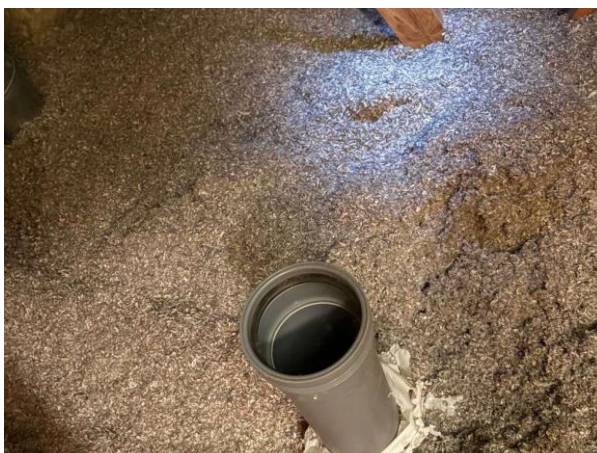
Bild 4: Utvändigt, Vind, Luftningen till avloppet är inte ihopkopplat med genomföringen i taket (ska kopplas ihop) Köksfläkten avslutas på vinden (ska dras ut genom...)
