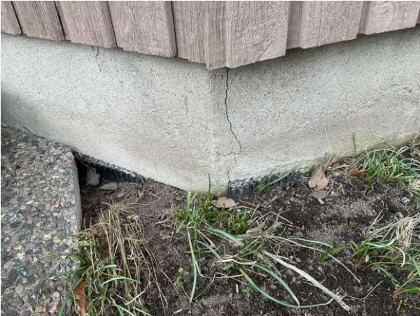
Bild 1: Utvändigt, Grundmur/Hussockel, Enstaka spricka noteras på grundmuren
