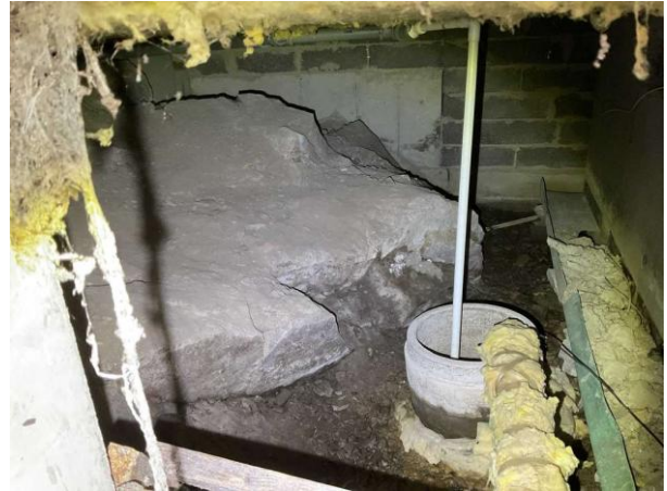
Bild 2: Utvändigt, Krypgrund/outgrävt utrymme, Fukt noteras på krypgrundsmarken, Plastfolie saknas på krypgrundsmarken se riskanalys
