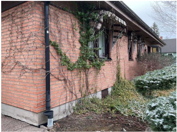
Bild 4: Utvändigt, Fasad, Klängväxter noteras på fasaden
