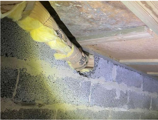
Bild 3: Utvändigt, Grund, mikrobiell påväxt noteras på bjälklaget
