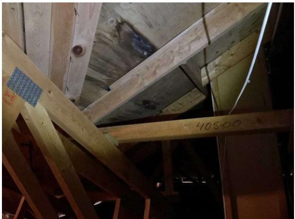
Bild 6: Utvändigt, Vind Lokalt på vinden noterades det fuktrosor på underlagsskivorna se fortsatt teknisk utredning,
