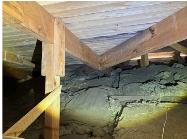
Bild 4: Utvändigt, Vind, Luftningen till avloppet avslutas på vinden Lokalt noterades mikrobiell påväxt på underlagstaket Spår av tidigare läckage noterades
