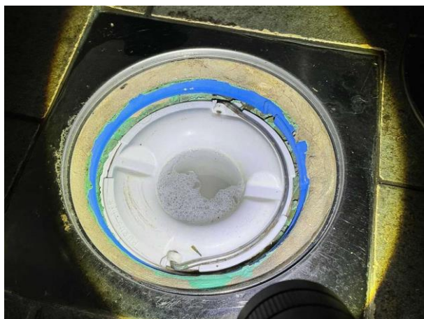
Bild 7: Invändigt, Souterrängplan, Duschrum, Brunnsduken är synlig under klämringen (ej korrekt tillskuren) Klämringen är monterad upp och ned samt är den inte nedtryckt mot Klämringen...
