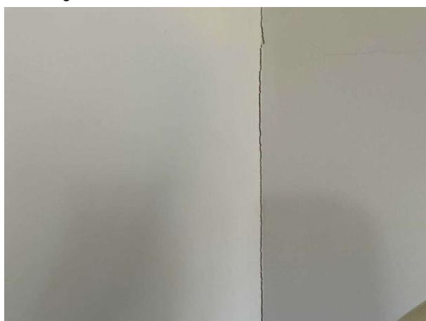
Bild 9: Invändigt, Entréplan, Vardagsrum, Spricka noterades i tak och väggvinkel
