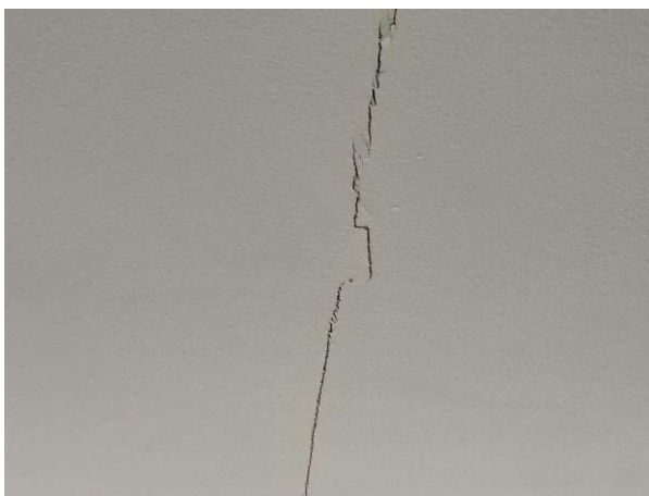
Bild 8: Invändigt, Entréplan, Vardagsrum, Spricka noterades i tak och väggvinkel
