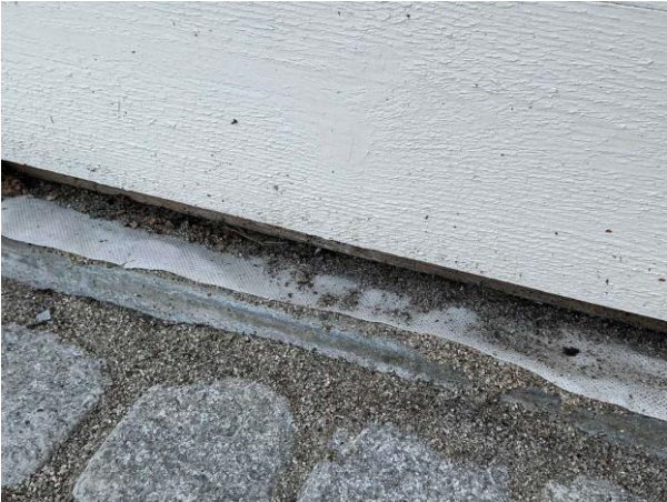
Bild 1: Utvändigt, Fasad, Plåt saknas vid garaget (nere mot betongen)
