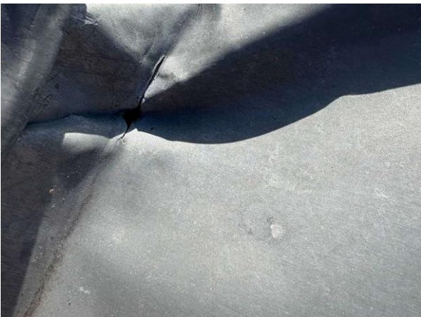
Bild 5: Utvändigt, Yttertak, 2 mindre hål noterades i nockfalsen Nockfalsen är delvis något lös
