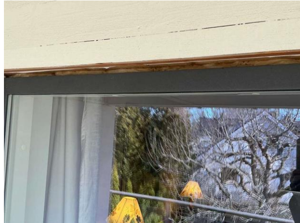
Bild 2: Utvändigt, Fönster, Smyg saknas i ovkant på två fönster
