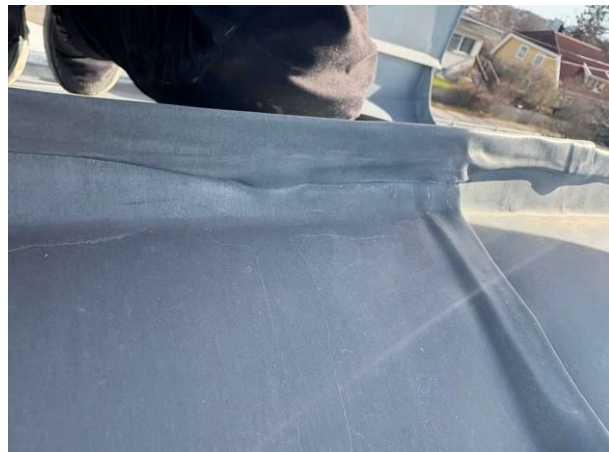
Bild 6: Utvändigt, Yttertak, 2 mindre hål noterades i nockfalsen Nockfalsen är delvis något lös
