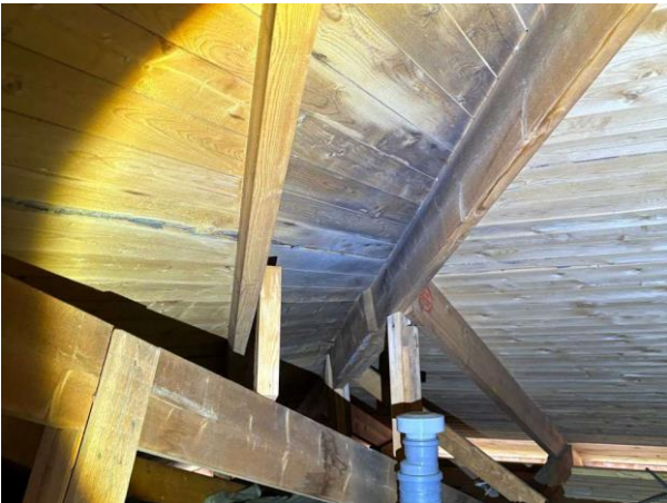
Bild 3: Utvändigt, Vind, Luftningen till avloppet avslutas på vinden Lokalt noterades mikrobiell påväxt på underlagstaket Spår av tidigare läckage noterades (
