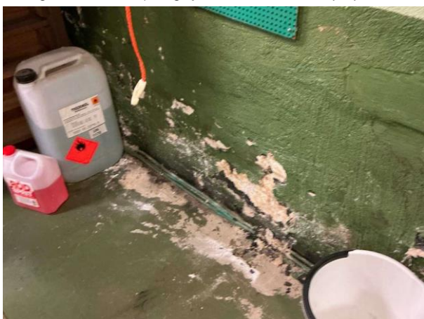
Bild 5: Invändigt, Källarplan, Verkstad, Fuktgenomslag noterades på källarväggens nedre del.
