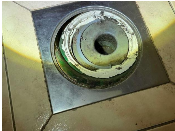
Bild 10: Invändigt, Entréplan, Badrum, Äldre våtrum se riskanalysen Det förekommer rörgenomföringar i vägg under badkaret Plant golv vid badkaret Tätskikt monterat över klämringe...
