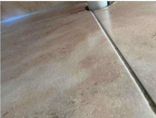
Bild 9: Invändigt, Entréplan, Badrum, Äldre våtrum se riskanalysen Det förekommer rörgenomföringar i vägg under badkaret Plant golv vid badkaret Tätskikt monterat över klämringe...
