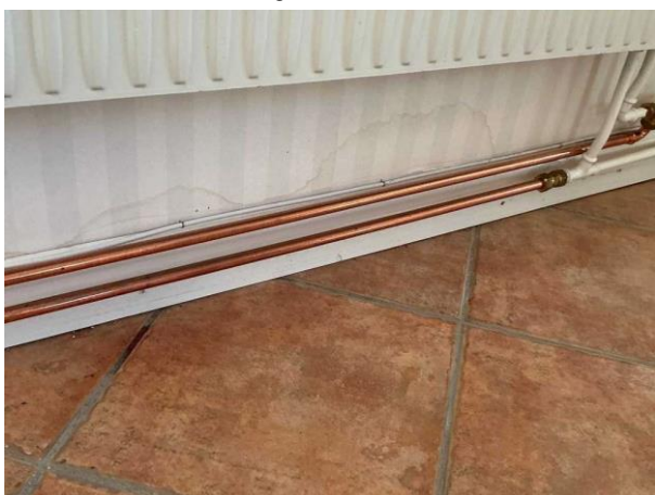
Bild 3: Invändigt, Källarplan, Vardagsrum/biljard, Äldre fuktfläckar på den källarväggens nedre kant (ej kontrollerat i väggen). Sk bomgolv noterades (ihålligt ljud när man knackar på plattorna...).
