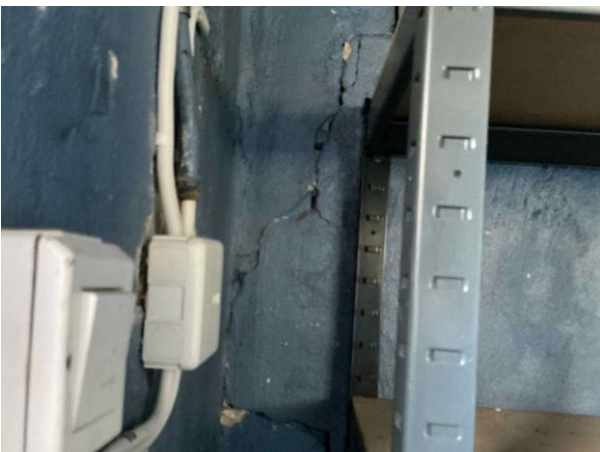
Bild 11: Invändigt, Entréplan, Garage, Sprickor i murade innerväggar Äldre gjutjärnsbrunn (rost noterades)
