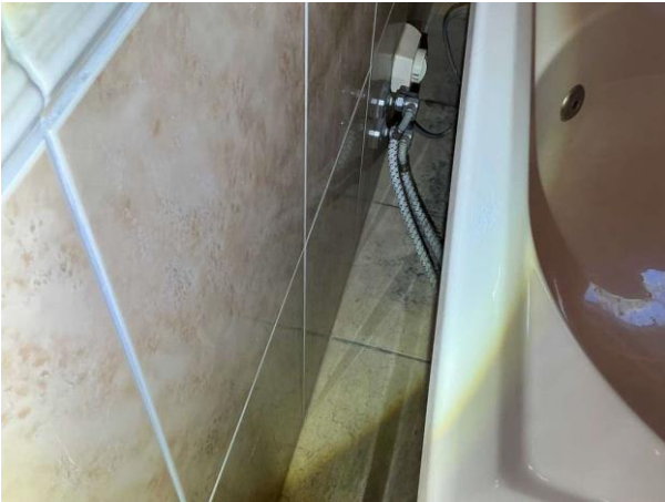
Bild 7: Invändigt, Entréplan, Badrum, Äldre våtrum se riskanalysen Det förekommer rörgenomföringar i vägg under badkaret Plant golv vid badkaret Tätskikt monterat över klämringe...
