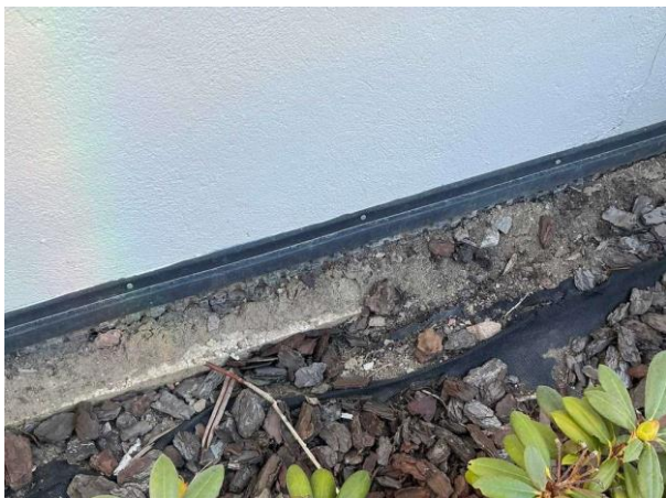
Bild 1: Utvändigt, Mark, Äldre dränering se riskanalysen. Marken lutar mot husgrunden. Grundens isolering är inte täckt av markduk vid rabatt. Rabatt mot husgrund för...
