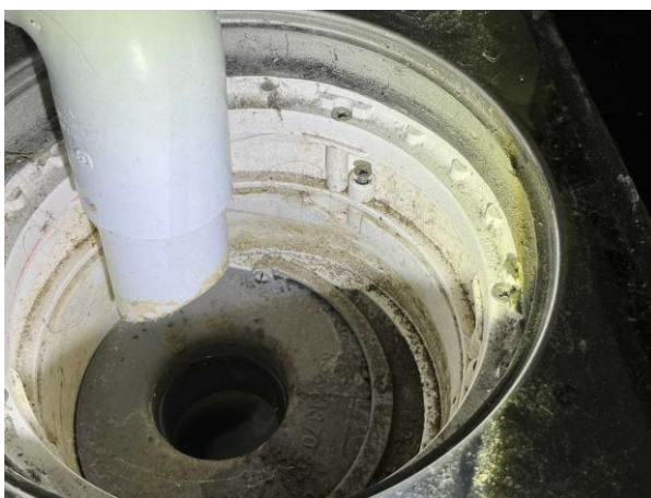
Bild 4: Invändigt, Källarplan, Tvättstuga, En skruv i förhöjningsringen i golvbrunnen är inte fullt nedskruvad.
