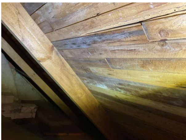
Bild 11: Invändigt, Övervåning/halvplan, Kattvind 1, Lokalt på vinden noterades det mikrobiell påväxt på underlagstaket Se riskanalys
