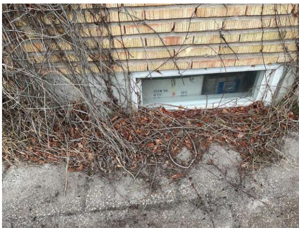
Bild 4: Utvändigt, Fönster, Otätt vid fönster mot fasaden Marknära fönster finns i souterrängplan
