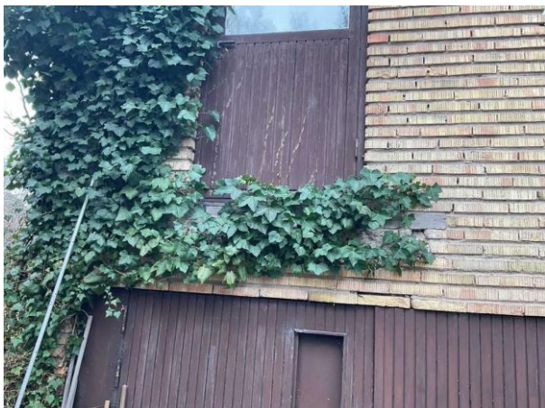
Bild 1: Utvändigt, Fasad, Bristfälligt med fog noteras kring teglet Enstaka tegel är trasigt, Klångväxter noteras på fasaden Tidigare entrétrappa är borttagen
