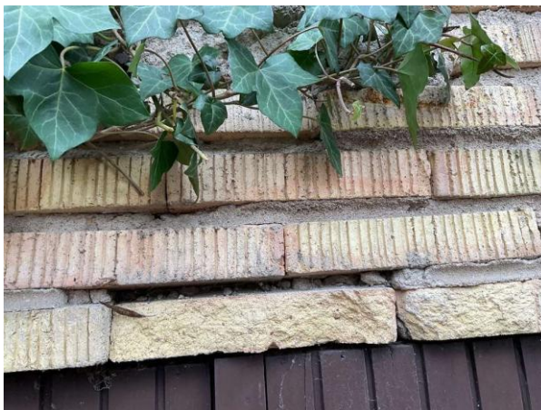
Bild 2: Utvändigt, Fasad, Bristfälligt med fog noteras kring teglet Enstaka tegel är trasigt
