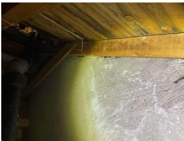
Bild 12: Invändigt, Övervåning/halvplan, Kattvind 1, Lokalt på vinden noterades det mikrobiell påväxt på underlagstaket Se riskanalys
