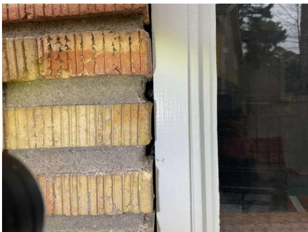
Bild 3: Utvändigt, Fönster, Otätt vid fönster mot fasaden Marknära fönster finns i souterrängplan
