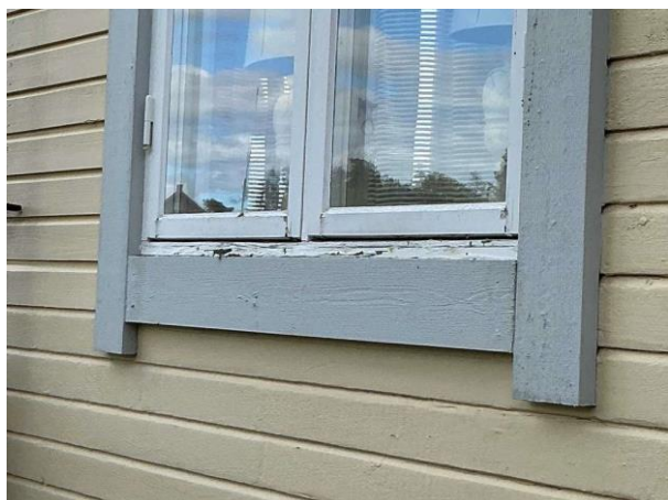
Bild 7: Utvändigt, Fönster, Färgsläpp noteras på karm Fönsterbleck saknas på ett fönster se riskanalysen
