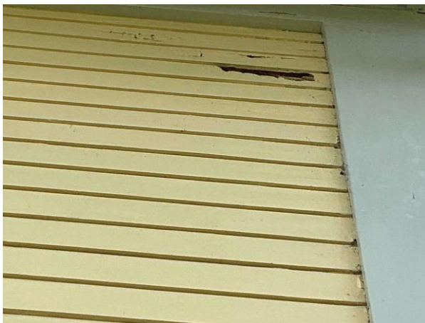
Bild 19: Utvändigt, Fasad, Rötskada i träpanel noterades lokalt
