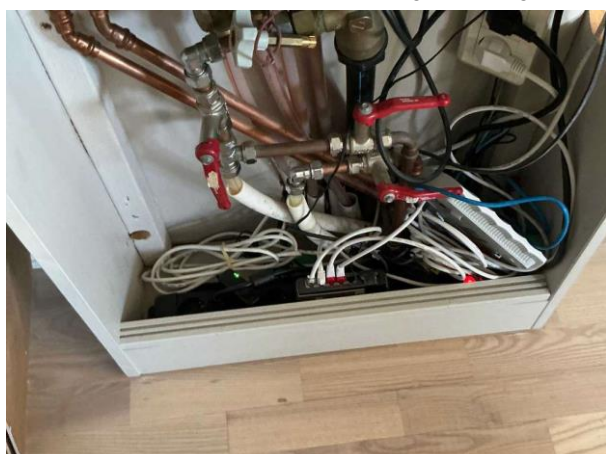
Bild 11: Invändigt, Källarplan, Kök/pentry/lägenhet, Tätbotten saknas i diskbänkskåpet samt under diskmaskin Golvvärmekopplingar saknas bakomliggande tätskikt med skvallerrör
