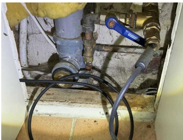
Bild 21: Invändigt, Källarplan, Sovrum 1, Inbyggnad för vattenkopplingar i garderob saknas bakomliggande tätskikt
