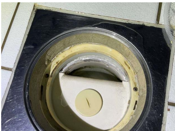
Bild 17: Invändigt, Övervåning, Badrum, Äldre våtrum se riskanalysen Vattenkopplingar i kattvind, saknar bakomliggande, tätskikt och avledning till golvbrunn Äldre golvbrunn noter...
