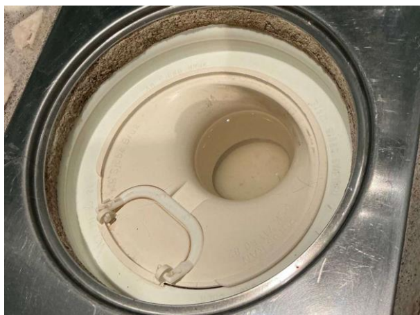
Bild 9: Invändigt, Källarplan, Badrum, Äldre våtrum se riskanalys Brunnsduk, tätskikt och klämning saknas i golvbrunn för dusch och badkaret Inkommande vatten med rörgenomföring...
