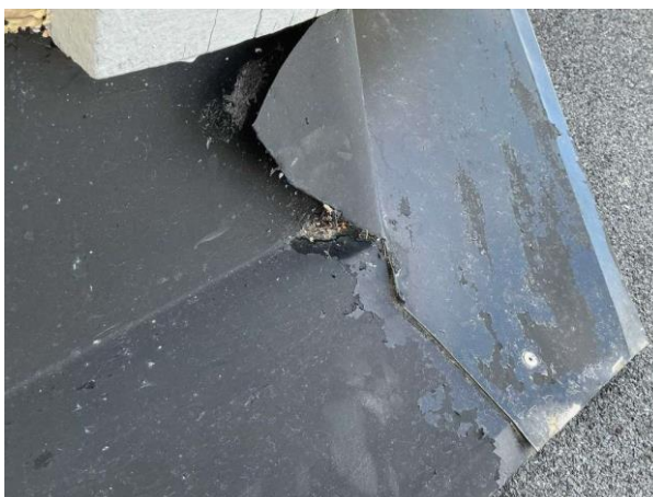
Bild 8: Utvändigt, Yttertak, Taket är besiktat i anslutning till taklucka inget särskilt att notera Ett plåtbleck glipar på det låglutande taket
