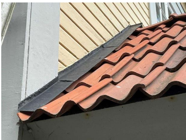
Bild 20: Utvändigt, Yttertak, Stege saknas besiktning av det högre taket utgår ej besiktat Tak ovan entré Hängrännor saknas Ej ströläkt till takfot vilket medför svacka...
