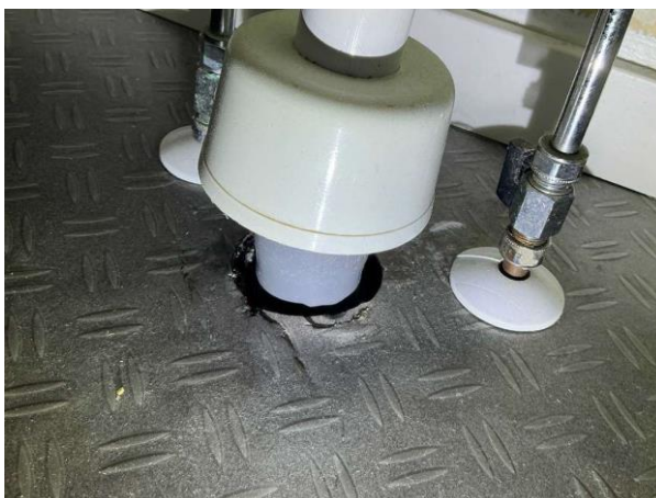
Bild 14: Invändigt, Entréplan, Wc, Otätt runt rörgenomföringar i golv
