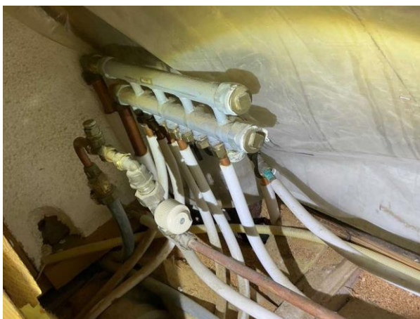
Bild 16: Invändigt, Övervåning, Badrum, Äldre våtrum se riskanalysen Vattenkopplingar i kattvind, saknar bakomliggande, tätskikt och avledning till golvbrunn Äldre golvbrunn noter...
