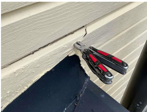
Bild 4: Utvändigt, Fasad, Övermålad rötskada noterades i fasad Under entrédörr saknas panelbit/bleck öppet in till vägg Missfärgning på träpanel på tillbyggnad Marken...
