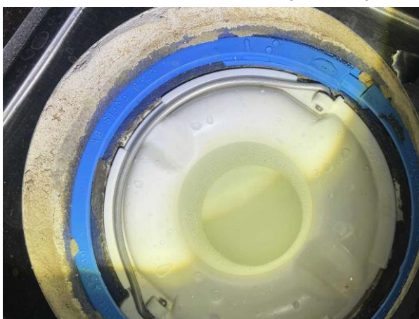
Bild 12: Invändigt, Källarplan, Duschrum, Brunnsduk är inte korrekt tillskuren och synlig under klämringen Kvalitetsdokument saknas Det förekommer rörgenomföringar i golv som saknar...
