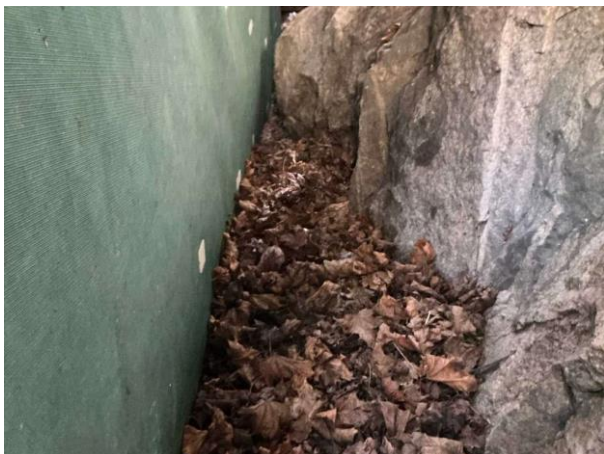
Bild 18: Utvändigt, Mark, Berget lutar mot grunden Ficka med löv mot grundmuren på baksidan
