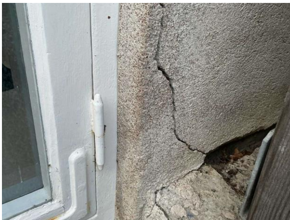
Bild 2: Utvändigt, Grundmur/Hussockel, Platonmatta mot grundmur saknar topplist och glipor mot grundmuren Lös puts noterades på ett ställe
