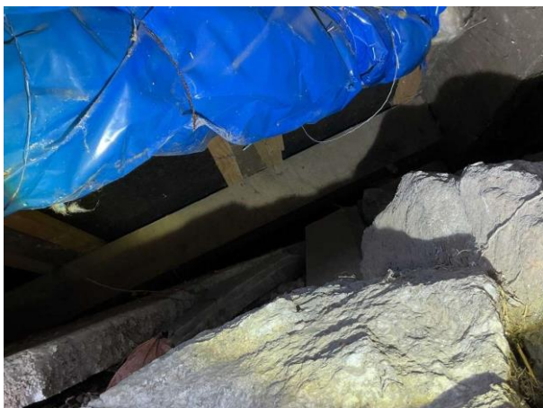
Bild 3: Utvändigt, Plintgrund, Tillbyggnaden är utförd på en väldigt marknära plintgrund Fuktavvisande plastfolie saknas över marken Endast väldigt begränsat besiktad i...
