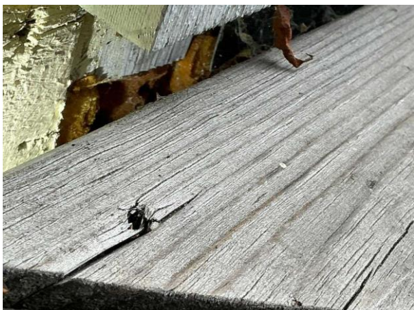
Bild 5: Utvändigt, Fasad, Övermålad rötskada noterades i fasad Under entrédörr saknas panelbit/bleck öppet in till vägg Missfärgning på träpanel på tillbyggnad Marken...
