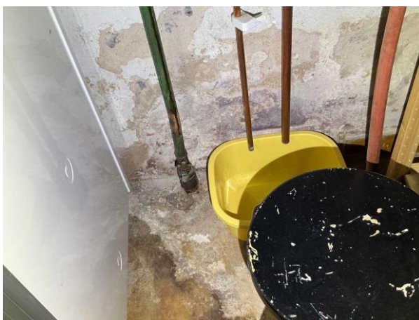
Bild 4: - Invändigt, Källarplan, Fuktgenomslag i innerväggarnas nedre kant Äldre gjutjärnsbrunn
