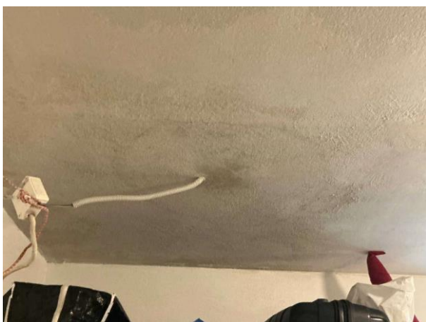
Bild 3: Invändigt, Källarplan, Äldre fuktfläck i tak från tidigare läckage från en avluftning som är lagad (torr vid besiktningen)
