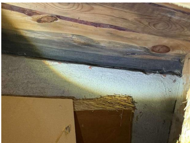
Bild 5: - Invändigt, Övervåning, Besiktad från luckan Blånad spår av kondens mot takfoten noterades
