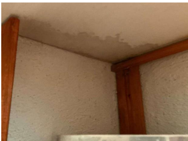
Bild 1: Invändigt, Källarplan, Äldre fukthäcken från tidigare läckage under hylla torr vid besikningen
