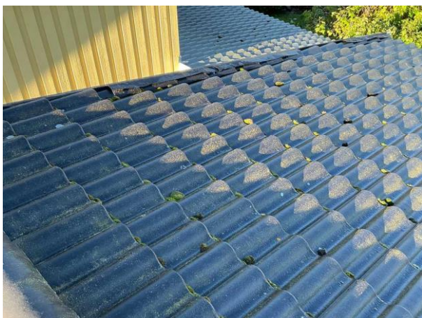
Bild 3: - Utvändigt, Yttertak, Mossa noterades på taket Takfot är missfärgad och har behov av målning Äldre plåtgenomföringar oc...
