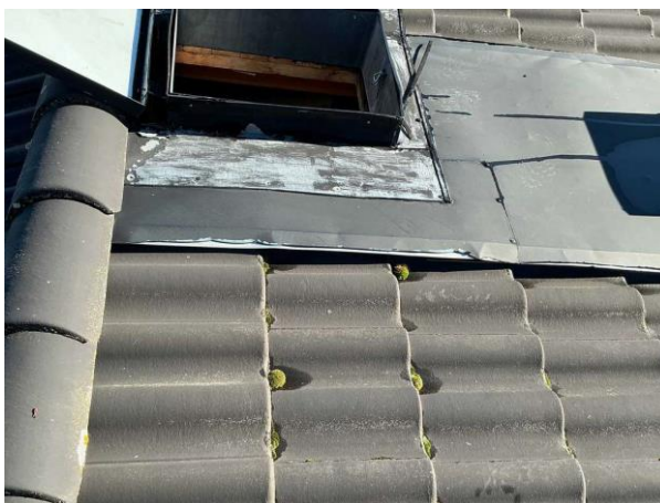
Bild 4: - Utvändigt, Yttertak, Mossa noterades på taket Takfot är missfärgad och har behov av målning Äldre plåtgenomföringar oc...
