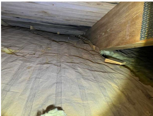
Bild 2: - Utvändigt, Vind, Vind ovan garage och vardagsrum samt del av kök saknar lucka ej besiktad/utgår Nockvind besiktad ...
