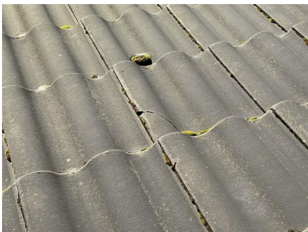
Bild 5: - Utvändigt, Yttertak, Mossa noterades på taket Takfot är missfärgad och har behov av målning Äldre plåtgenomföringar oc...
