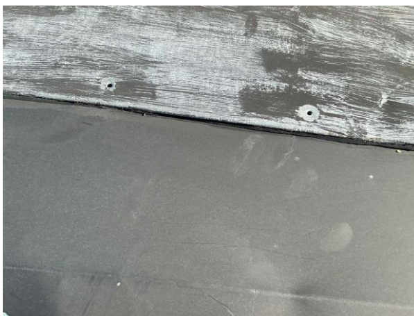
Bild 6: - Utvändigt, Yttertak, Mossa noterades på taket Takfot är missfärgad och har behov av målning Äldre plåtgenomföringar oc...
