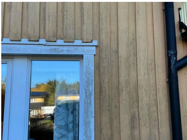
Bild 1: - Utvändigt, Fasad, Färgsläpp på foder runt fönster Lokalt noterades färgsläpp och torrsprickor på träpanel Missfärgn...
