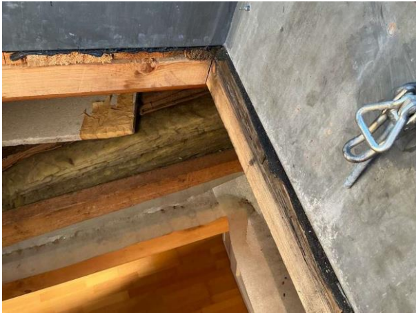
Bild 7: - Utvändigt, Yttertak, Mossa noterades på taket Takfot är missfärgad och har behov av målning Äldre plåtgenomföringar oc...
