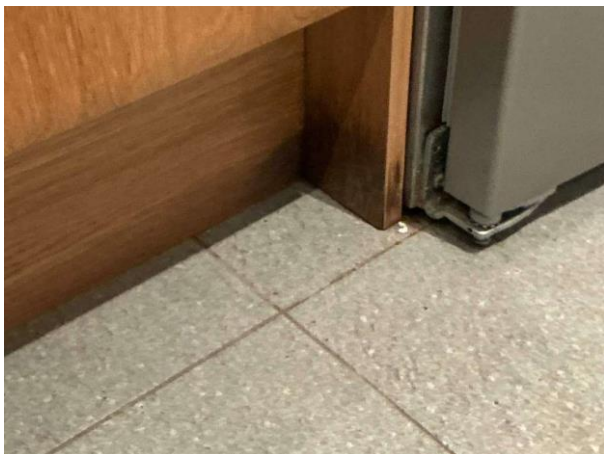
Bild 7: - Invändigt, Entréplan, Fuktskada i skåpsida vid kylskåp Vattenledningar med kopplingar saknar klammer i diskbänksskåpet....
