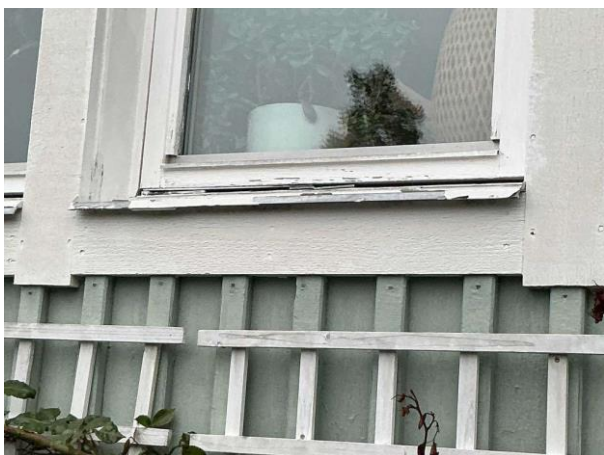
Bild 3: - Utvändigt, Fönster, Äldre isolerglaskassetter Bakfall på bleck vid källarfönster Färgsläpp noterades på fönsterbågar ...
