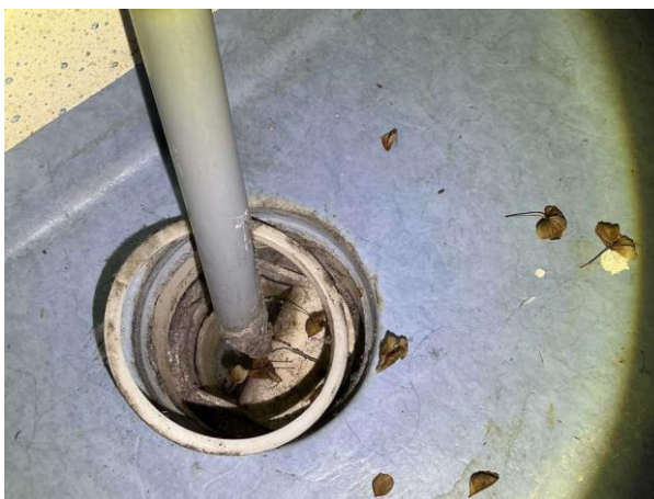
Bild 4: - Invändigt, Souterrängplan, Äldre plastmatta Klämringen är lös i golvbrunnen Lock saknas på eldosor Inbyggnad för inkommand...
