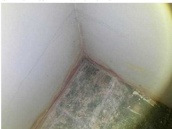
Bild 15: Invändigt, Källarplan, Missfärgning påväxt på innervägg
