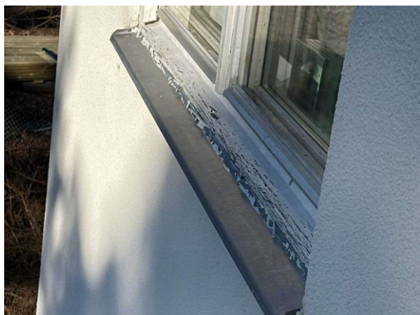
Bild 7: - Utvändigt, Fönster, Färgsläpp och allmänt underhållsbehov på fönster noterades Putskant saknas på fönsterbleck
