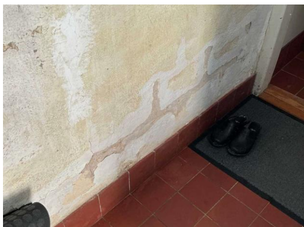
Bild 23: Invändigt, Källarplan, Putssläpp på ytterväggar
