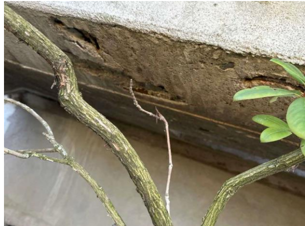
Bild 4: Utvändigt, Entretrappa, Urslag och skador i betongen under entretrappan
