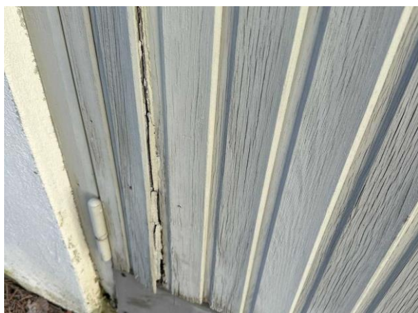
Bild 11: - Utvändigt, Utvändigt garage, Missfärgning mikrobiell påväxt på tak betongbjälklag Garagedörr skadad och sprucken panel
