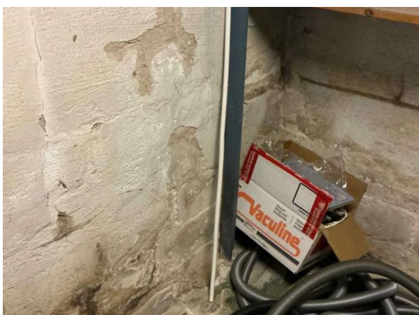
Bild 17: - Invändigt, Källarplan, Missfärgning Fuktgenomslag på yttervägg Spricka i innervägg
