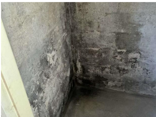
Bild 13: - Invändigt, Källarplan, Fuktgenomslag och mikrobiell påväxt på vägg Vattenkoppling till garage
