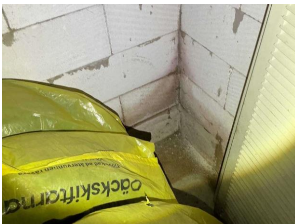
Bild 20: - Invändigt, Källarplan, Äldre rostig gjutjärnsbrunn Fuktgenomslag i källarväggar med mögelpåväxt på golv Synlig rostig ar...
