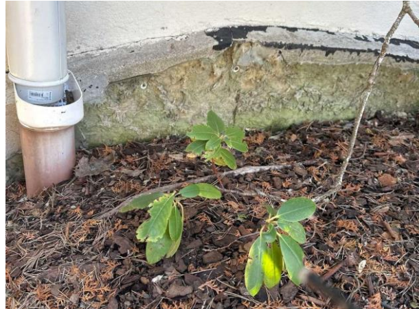
Bild 2: Utvändigt, Mark, Äldre dränering, en dränerings tekniska livslängd beräknas till 25år, denna dränering har uppnått...
