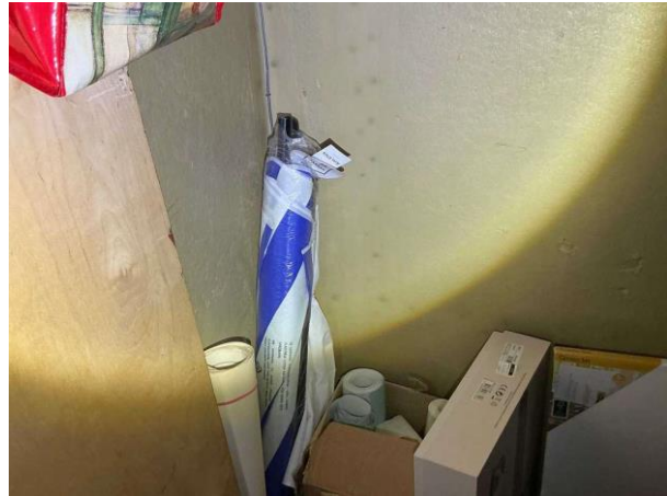
Bild 26: Invändigt, Entréplan, Köldbryggor noterades på väggar (mörka fält på spikskallar etc)
