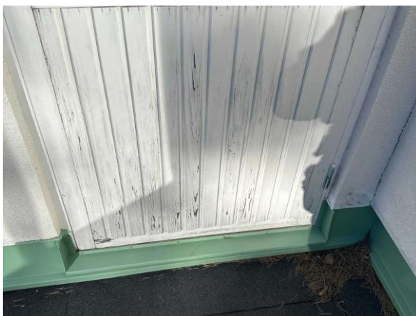
Bild 8: Utvändigt, Ytterdörr, Färgsläpp noterades på altandörrar
