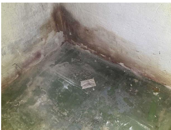
Bild 22: Invändigt, Källarplan, Fuktgenomslag noterades i källarväggens nedre kant
