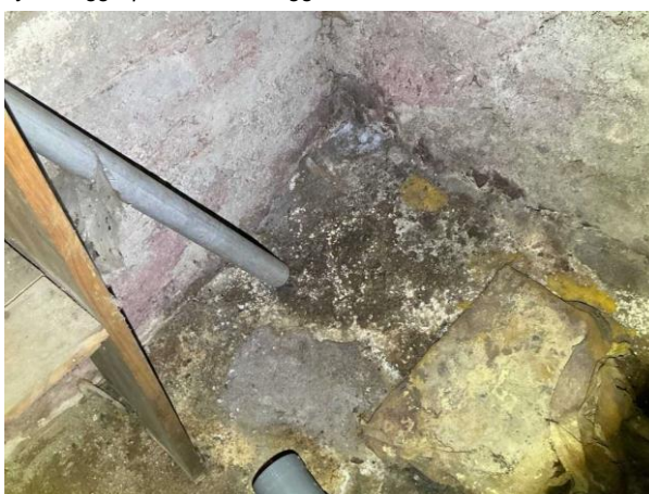
Bild 18: - Invändigt, Källarplan, Äldre rostig gjutjärnsbrunn Fuktgenomslag i källarväggar med mögelpåväxt på golvet Synlig rostig ar...
