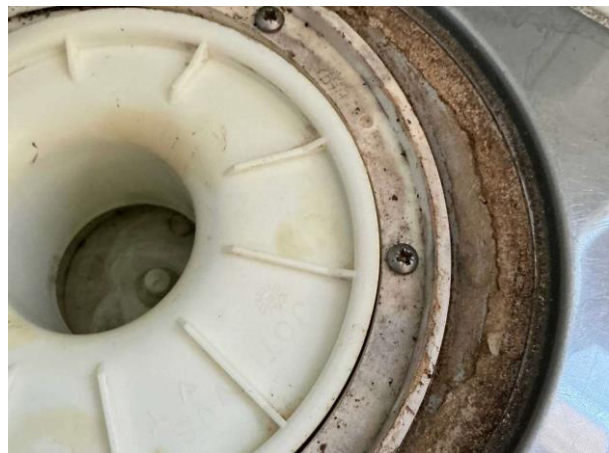
Bild 30: - Invändigt, Överväning, Äldre våtrum Kvalitetsdokument saknas Brunnsduk saknas Äldre golvbrunn av plast Hål i vägg duschz...
