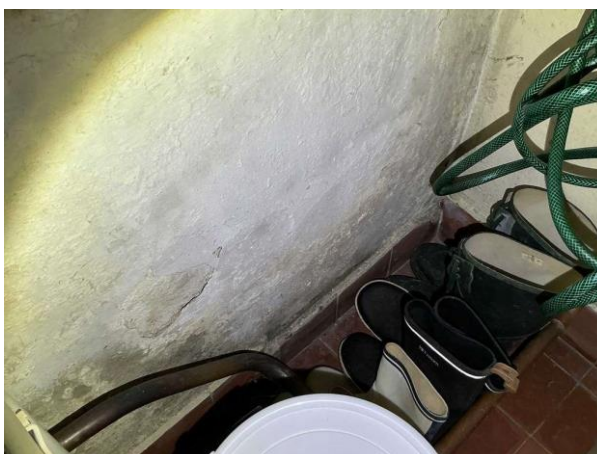
Bild 24: - Invändigt, Källarplan, Äldre standard Golvbrunn av gjutjärn Putssläpp och Fuktgenomslag i källarväggarnas nedre kant
