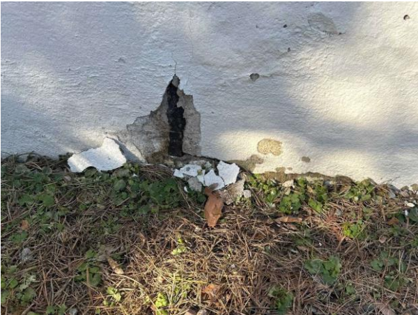
Bild 3: Utvändigt, Grundmur/Hussockel, Putssläpp och färgsläpp noterades lokalt i grundmuren
