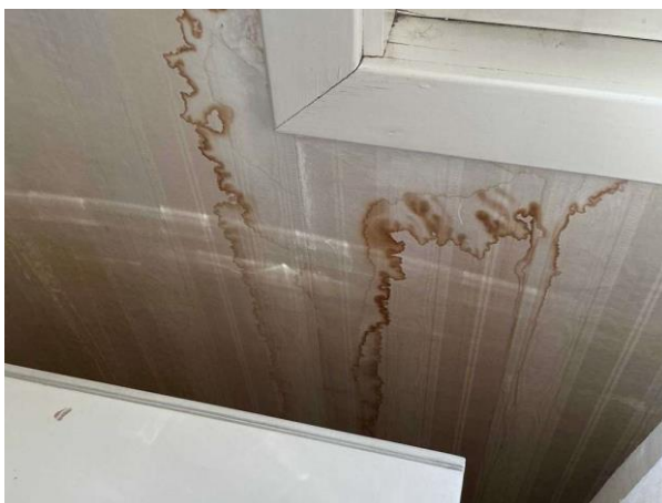
Bild 32: Invändigt, Övervåning, Spår av äldre läckage på vägg innan fönsterbyte
