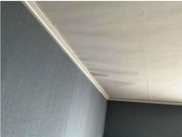
Bild 27: - Invändigt, Entréplan, Missfärgning i golv runt värmerör Skador i vävtak
