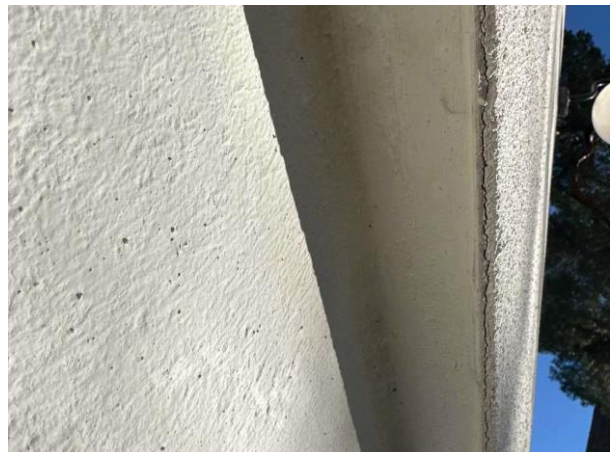
Bild 6: - Utvändigt, Fasad, Putslagning och spricka i puts noterades på fasad från låga taket Fasaden är delvis tilläggsisole...
