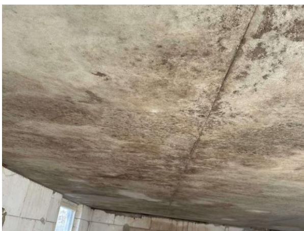
Bild 10: - Utvändigt, Utvändigt garage, Missfärgning mikrobiell påväxt på tak betongbjälklag Garagedörr skadad och sprucken panel
