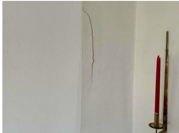
Bild 28: Invändigt, Entréplan, Spricka i puts vid öppenspis
