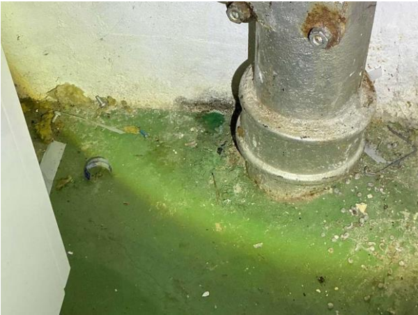
Bild 25: - Invändigt, Källarplan, Äldre standard Dropp från värmesystem noterades bakom värmepump Äldre gjutjärnsbrunn Urslag ur b...
