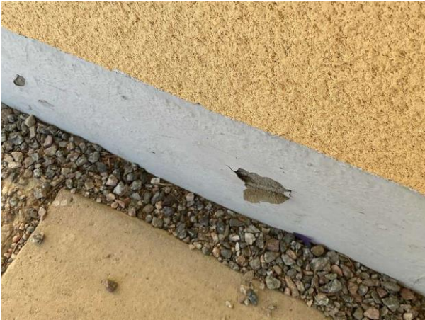
Bild 1: - Utvändigt, Fasad, Flagor, Färgsläpp, lagningar, sprickor och bomputs förekommer behov av reparation omputsning Lös...
