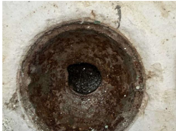
Bild 28: - Invändigt, Entréplan, Äldre golvbrunn av gjutjärn (rost noterades). Fuktgenomslag och lokalt mikrobiell påväxt noterades...
