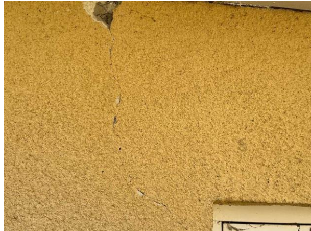
Bild 4: - Utvändigt, Fasad, Flagor, Färgsläpp, lagningar, sprickor och bomputs förekommer behov av reparation omputsning Lös...
