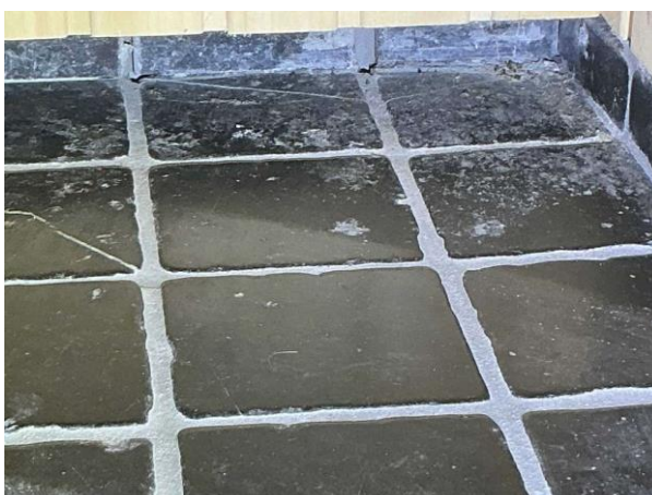
Bild 36: - Invändigt, Entréplan, Fogsläpp noterades på klinker Golvbrunnens anslutning är dold av sättbruk
