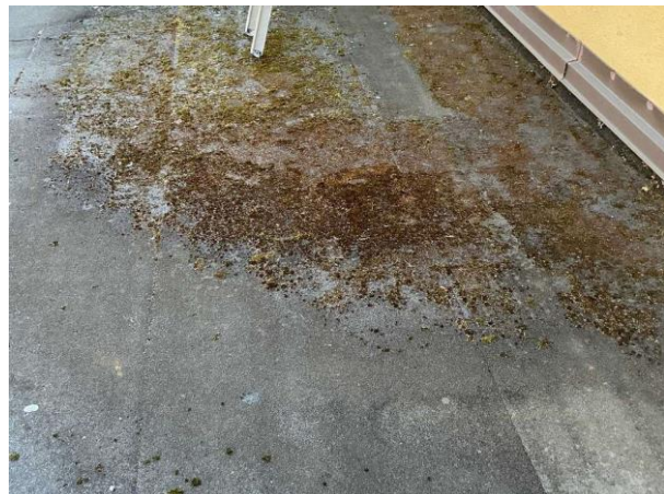
Bild 18: - Utvändigt, Yttertak, Tak ovan huvudbyggnad besiktat i anslutning till taksäkerhet Färgsläpp och missfärgningar av takf...
