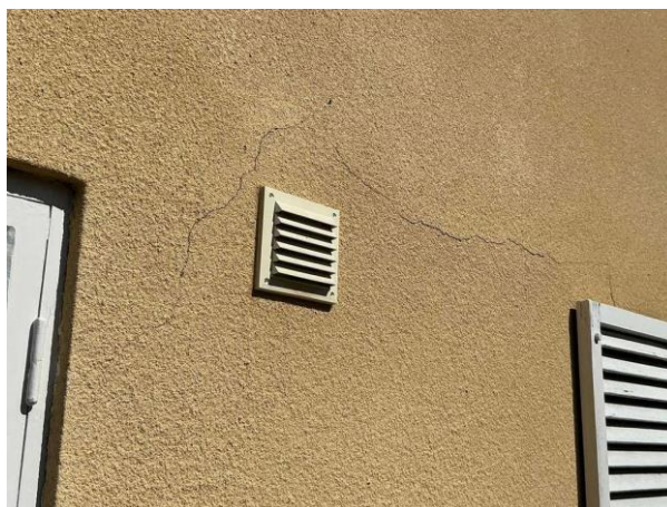
Bild 10: - Utvändigt, Fasad, Flagor, Färgsläpp, lagningar, sprickor och bomputs förekommer behov av reparation omputsning Lös...
