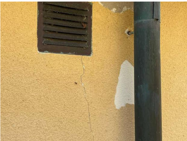
Bild 5: - Utvändigt, Fasad, Flagor, Färgsläpp, lagningar, sprickor och bomputs förekommer behov av reparation omputsning Lös...
