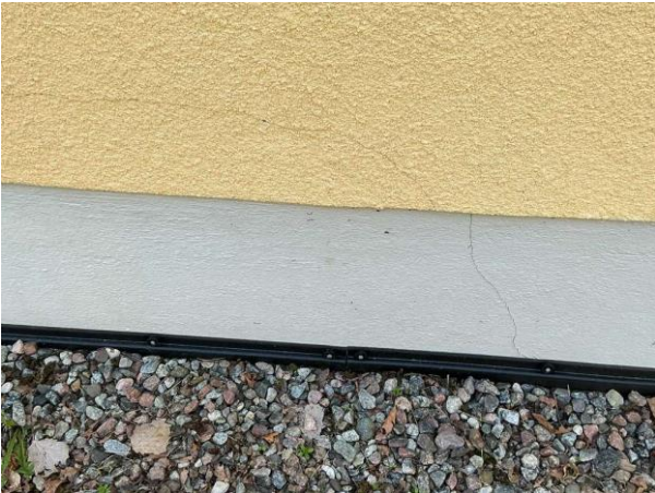
Bild 3: - Utvändigt, Fasad, Flagor, Färgsläpp, lagningar, sprickor och bomputs förekommer behov av reparation omputsning Lös...
