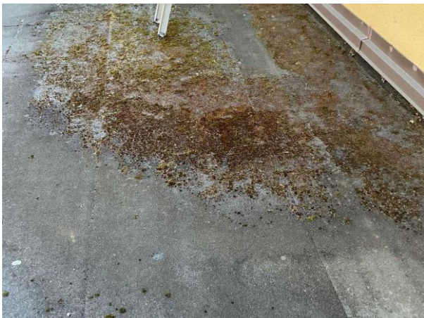
Bild 17: - Utvändigt, Yttertak, Tak ovan huvudbyggnad besiktat i anslutning till taksäkerhet Färgsläpp och missfärgningar av takf...
