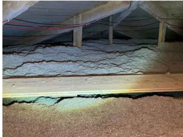
Bild 14: - Utvändigt, Vind, Del av vinden är besiktningsbar trygghetsvakt installerad och isolerad med isocell Vind tillbyggn...
