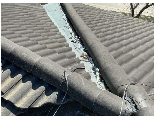
Bild 21: - Utvändigt, Yttertak, Tak ovan huvudbyggnad besiktat i anslutning till taksäkerhet Färgsläpp och missfärgningar av takf...
