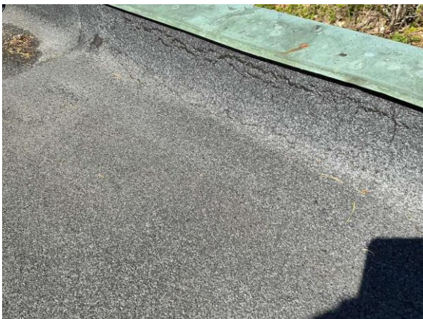
Bild 15: - Utvändigt, Yttertak, Tak ovan huvudbyggnad besiktat i anslutning till taksäkerhet Färgsläpp och missfärgningar av takf...
