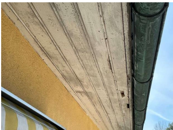
Bild 19: - Utvändigt, Yttertak, Tak ovan huvudbyggnad besiktat i anslutning till taksäkerhet Färgsläpp och missfärgningar av takf...
