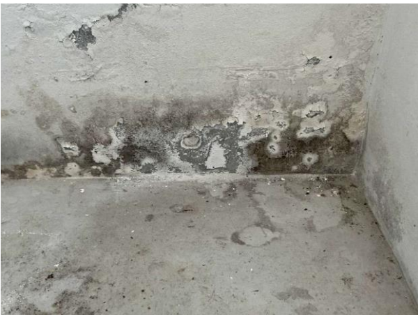
Bild 29: - Invändigt, Entréplan, Äldre golvbrunn av gjutjärn (rost noterades). Fuktgenomslag och lokalt mikrobiell påväxt noterades...
