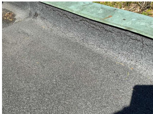
Bild 16: - Utvändigt, Yttertak, Tak ovan huvudbyggnad besiktat i anslutning till taksäkerhet Färgsläpp och missfärgningar av takf...
