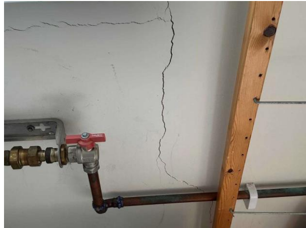
Bild 26: Invändigt, Entréplan, Spricka i grundmuren
