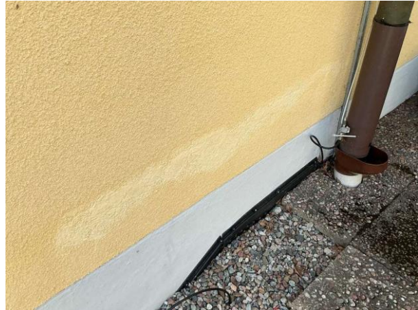
Bild 2: - Utvändigt, Fasad, Flagor, Färgsläpp, lagningar, sprickor och bomputs förekommer behov av reparation omputsning Lös...
