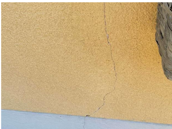
Bild 7: - Utvändigt, Fasad, Flagor, Färgsläpp, lagningar, sprickor och bomputs förekommer behov av reparation omputsning Lös...
