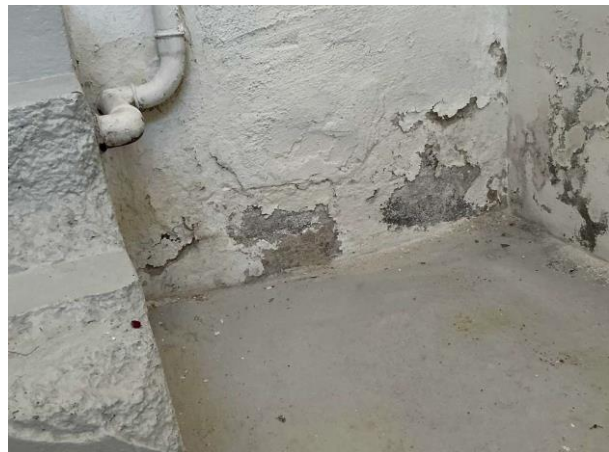
Bild 30: - Invändigt, Entréplan, Äldre golvbrunn av gjutjärn (rost noterades). Fuktgenomslag och lokalt mikrobiell påväxt noterades...
