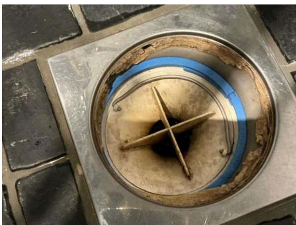
Bild 34: - Invändigt, Entréplan, Renoverat 2009 Kvalitetsdokument saknas Fuktmärken i karm till bastu
