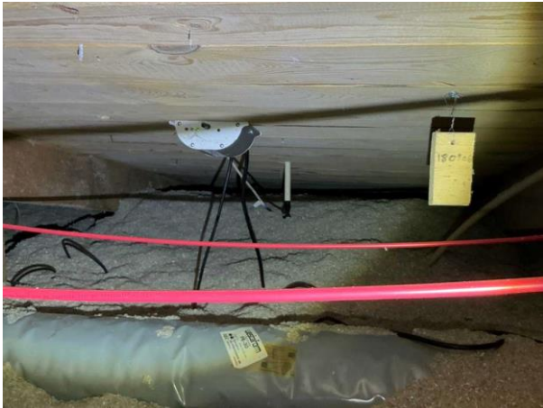
Bild 13: - Utvändigt, Vind, Del av vinden är besiktningsbar trygghetsvakt installerad och isolerad med isocell Vind tillbyggn...
