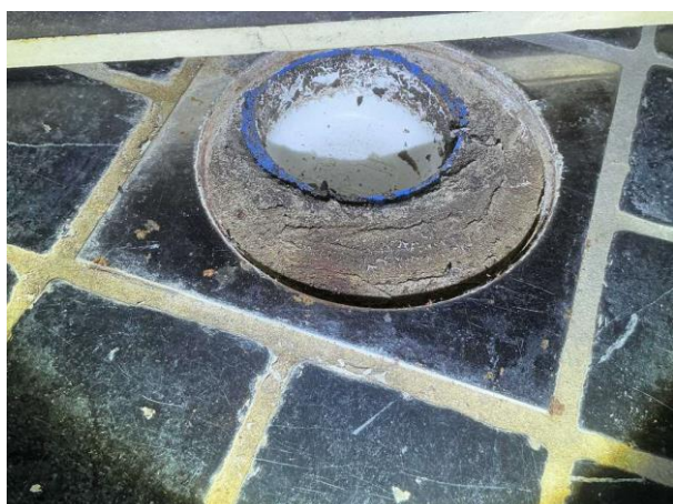
Bild 35: - Invändigt, Entréplan, Fogsläpp noterades på klinker Golvbrunnens anslutning är dold av sättbruk
