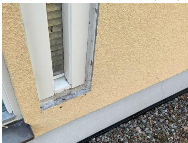
Bild 12: Utvändigt, Fönster, Bleck saknas vid vädringsfönster
