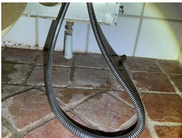
Bild 38: - Invändigt, Övervakning, Renoverat 2001 Äldre våtrum budgetera för renovering se riskanalysen Golvbrunnen är lågt placera...
