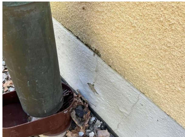
Bild 6: - Utvändigt, Fasad, Flagor, Färgsläpp, lagningar, sprickor och bomputs förekommer behov av reparation omputsning Lös...
