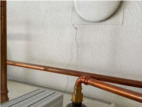
Bild 25: - Invändigt, Garage, Ytterväggar är belamrade med bohag och golvet är täckt med plastgolv. Golvbrunn saknas enligt sälj...
