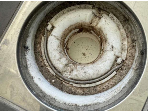
Bild 27: - Invändigt, Entréplan, Utfört utan tätskikt på golv och klämring saknas i golvbrunnen. Sk bomgolv noterades (ihåligt ljud...
