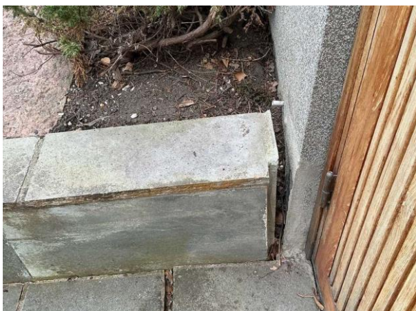
Bild 1: - Utvändigt, Mark, Lösa och ojämna stenplattor på entretrappa Entretrappa på gavel har lossnat från väggen Växter oc...
