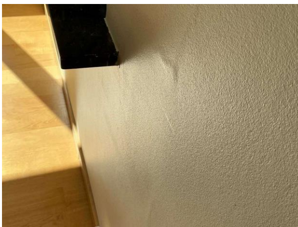
Bild 10: Invändigt, Plan 1, Bula på vägg vid fönster (det kan ha uppstått sprickor i bakomliggande vägg under tapet)
