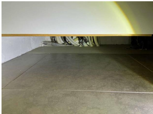
Bild 6: Invändigt, Souterrängplan, Det förekommer rörgenomföringar i golv annat än för avlopp
