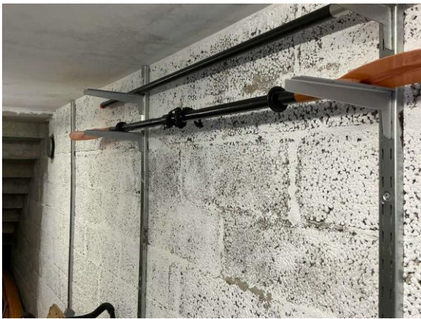
Bild 3: - Utvändigt, Kallförråd, Spår av genomfuktning på vägg mot rabatt Spricka i stenskit
