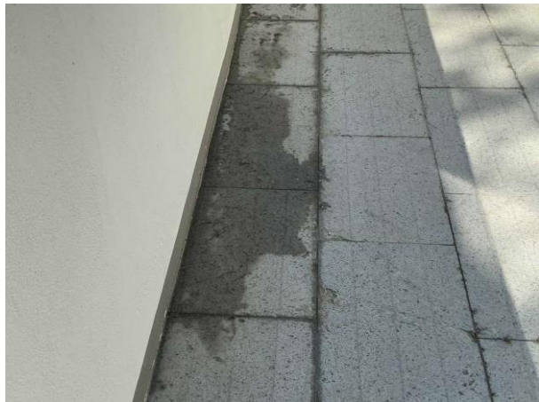
Bild 2: - Utvändigt, Terrass, Tätskikt är beklätt med sten (ej besiktat) Balkongen är underbyggd se riskanalysen Svacka på balk...
