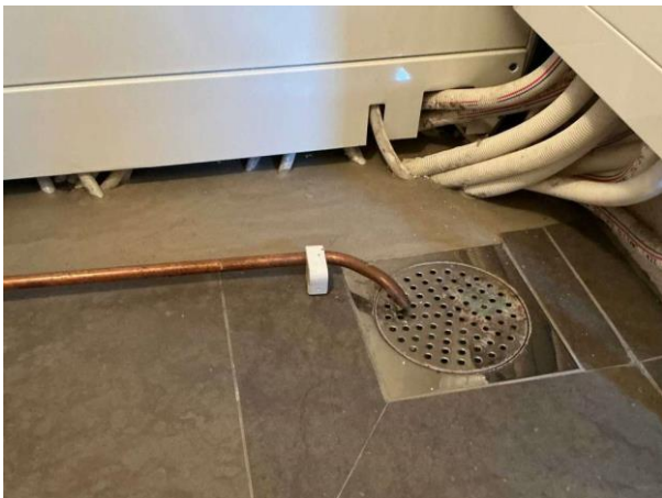
Bild 5: Invändigt, Souterrängplan, Det förekommer rörgenomföringar i golv annat än för avlopp
