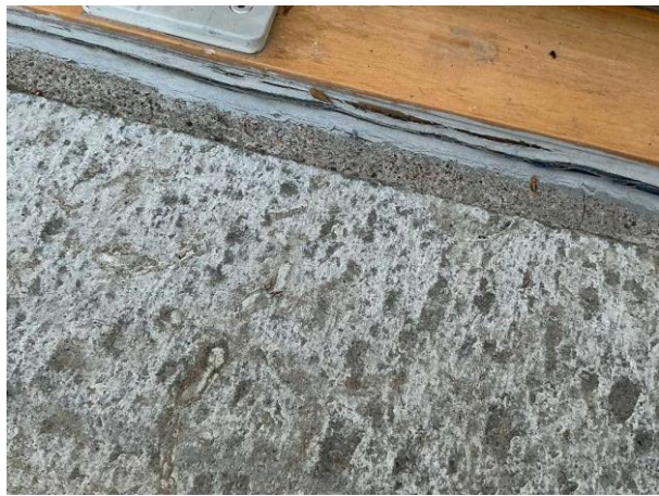
Bild 4: - Utvändigt, Terrass ovan garage, Tätskikt under stenplattor ej besiktat Underbyggd terrass (garage under) se riskanalysen Spricka ...
