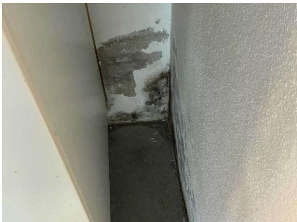
Bild 7: Invändigt, Garage, Fuktkänslighet noterades i källarväggs nedre kant
