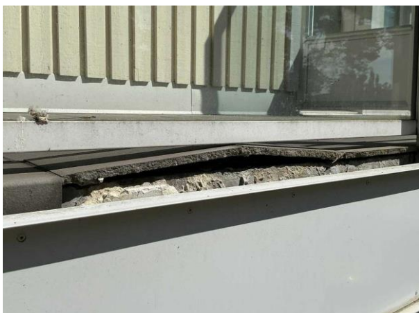
Bild 1: - Utvändigt, Terrass, Spruckna och lösa klinkerplattor tätskikt under klinkerplattor ej besiktningsbart Underbyggd ter...
