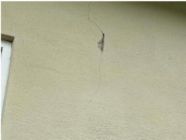
Bild 1: - Utvändigt, Fasad, Skada i puts framsidan samt baksidan Bomputs/lös puts vid gavel lilla entren
