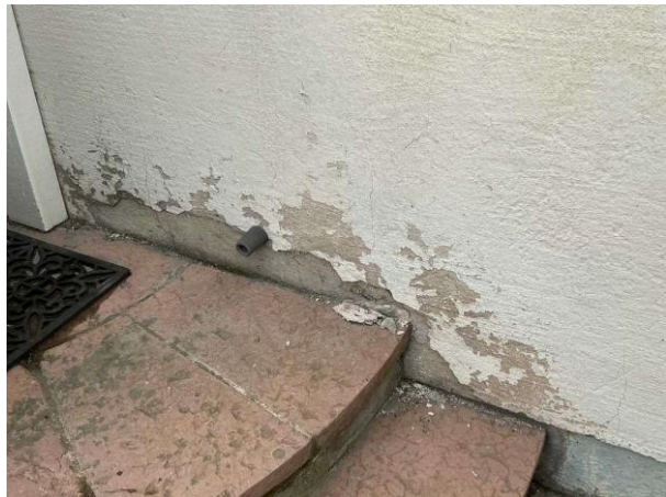
Bild 2: - Utvändigt, Fasad, Skada i puts framsidan samt baksidan Bomputs/lös puts vid gavel lilla entren
