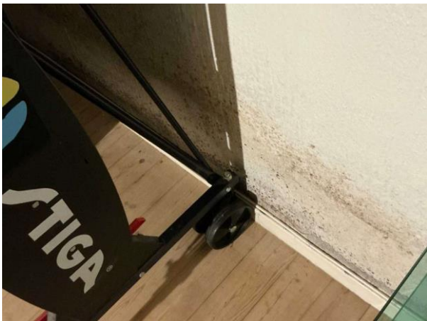
Bild 5: - Invändigt, Källarplan, Det förekommer uppreglade trägolv Mikrobiell påväxt noterades på källarväggens nedre kant
