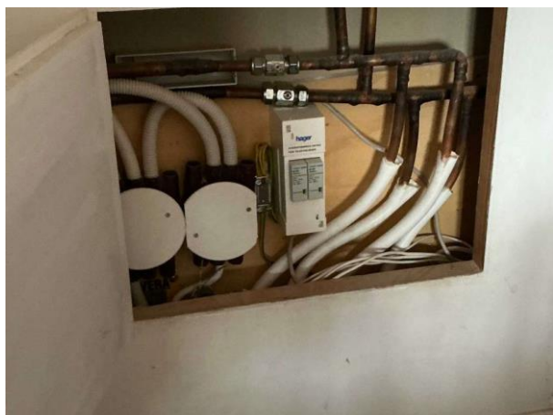
Bild 7: Invändigt, Inredd vind, Vattenkopplingar inbyggda saknar bakomliggande tätskikt och är placerat ihop med el
