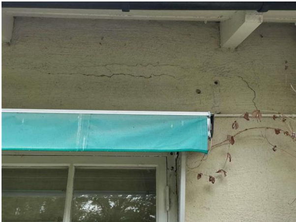
Bild 3: - Utvändigt, Fasad, Skada i puts framsidan samt baksidan Bomputs/lös puts vid gavel lilla entren
