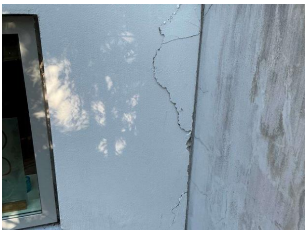
Bild 9: Utvändigt, Fasad, Sprickor förekommer i fasaden sprickor bör kontrolleras samt tätas/lagas av fackman
