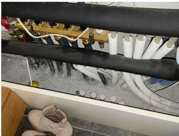
Bild 14: Invändigt, Entréplan, Golvvärmekopplingar ej utförda i tätt skåp med skvallerrör
