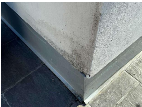
Bild 8: Utvändigt, Fasad, Sprickor förekommer i fasaden sprickor bör kontrolleras samt tätas/lagas av fackman
