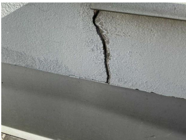
Bild 5: Utvändigt, Fasad, Sprickor förekommer i fasaden sprickor bör kontrolleras samt tätas/lagas av fackman
