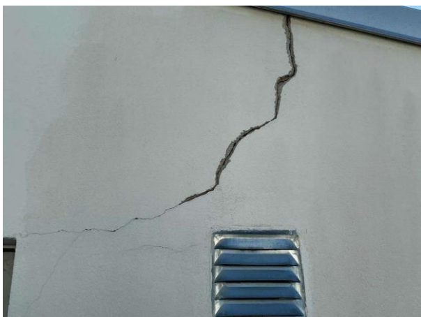
Bild 7: Utvändigt, Fasad, Sprickor förekommer i fasaden sprickor bör kontrolleras samt tätas/lagas av fackman
