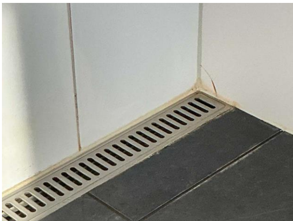
Bild 15: - Invändigt, Övre plan, Frånluftsventilation ur funktion Väggnära golvbrunn typ unidrain Kvalitetsdokument saknas Spr...
