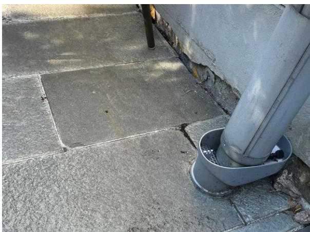
Bild 1: - Utvändigt, Mark, Marksättningar närmast husgrunden och i stentrappor etc Växter och buskar runt huset, en husgrun...
