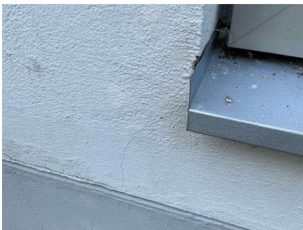
Bild 10: Utvändigt, Fönster, Fönsterbleck ej utförda med uppvikt puts kant
