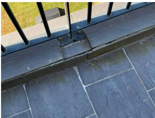
Bild 12: - Utvändigt, Balkong, Underbyggd balkong se riskanalysen Tätskikt under klinker är inte besiktningsbart Klinker är lö...
