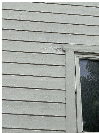
Bild 2: Utvändigt, Fasad, Lokal Rötskada i knutbröda och panel på gavel
