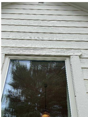
Bild 1: - Utvändigt, Fönster, Överbleck saknas. Rötskador i fönsterfoder
