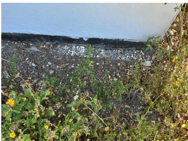
Bild 3: Utvändigt, Grundmur/Hussockel, Topplist har släppt mot dräneringen isodränskiva synlig, isodränskivan skall vara övertäckt med ...
