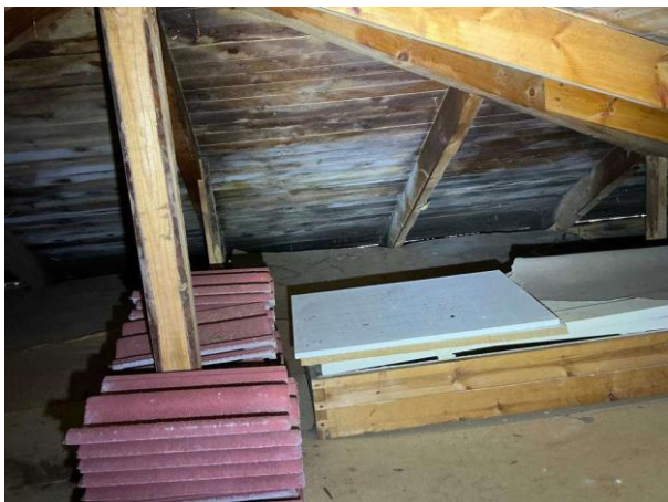
Bild 7: - Utvändigt, Vind, Mikrobiell påväxt (mögel) noterades på underlagstaket mot takfoten .
