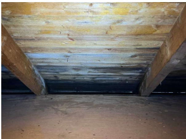
Bild 5: - Utvändigt, Vind, Mikrobiell påväxt (mögel) noterades på underlagstaket mot takfoten Huset är självdragsventilera...
