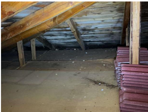
Bild 8: - Utvändigt, Vind, Mikrobiell påväxt (mögel) noterades på underlagstaket mot takfoten
