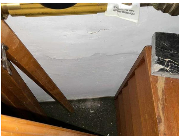
Bild 11: - Invändigt, Källarplan, Lös färg och puts noterades på källarväggens nedre kant .
