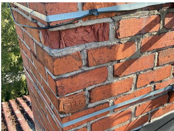
Bild 9: - Utvändigt, Yttertak, Frostsprängning skorsten..
