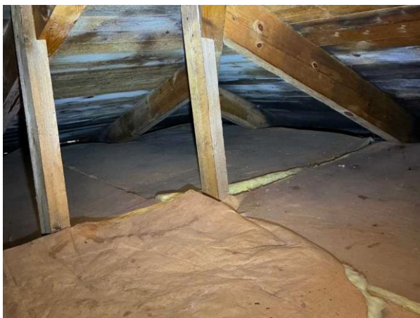
Bild 6: - Utvändigt, Vind, Mikrobiell påväxt (mögel) noterades på underlagstaket mot takfoten Huset är självdragsventilera...
