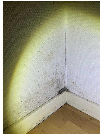
Bild 8: - Invändigt, Källarplan, Missfärgning noteras nedtill på yttervägg
