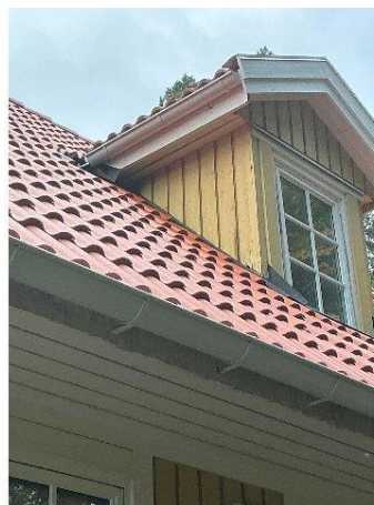
Bild 4: Utvändigt, Fasad, Färgsläpp och torrspäckor noteras på träpanelen
