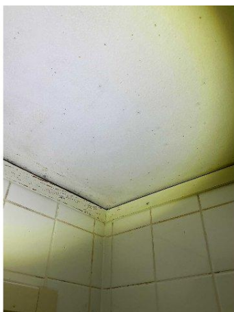
Bild 13: - Invändigt, Entréplan, Äldre våtrum Missfärgning/fläckar noteras på innertaket
