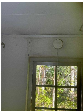
Bild 15: Invändigt, Entréplan, Missfärgning och fuktrosor noteras ovan fönster (torrt vid besiktningsstillfället) se säljuppsyn
