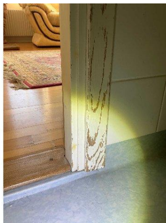
Bild 18: - Invändigt, Övervåning, Äldre våtrum färgsläpp noteras på dörrfoder
