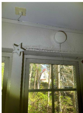
Bild 14: - Invändigt, Entréplan, Missfärgning och fuktrosor noteras ovan fönster (torrt vid besiktningsstillfället)
