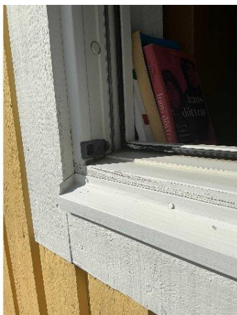
Bild 5: Utvändigt, Fönster, Äldre isolerglaskassetter. Isolerglas åldras och kan med tiden bli otäta. Färgsläpp noteras på fönster
