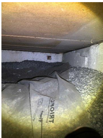
Bild 3: - Utvändigt, Grund, Uteluftventilerad kryppgrund bristfälligt utlagd plastfolie
