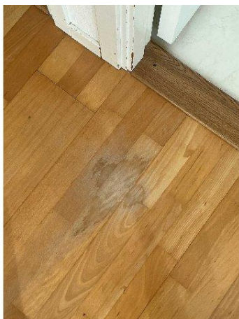
Bild 17: Invändigt, Övervåning, Missfärgning noteras lokalt på parkettgolvet
