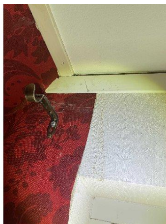
Bild 20: Invändigt, Övervåning, Missfärgning noteras ovan fönster (torrt vid besiktningsstillfället)
