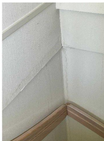
Bild 16: Invändigt, Övervåning, Missfärgning och fuktrosor noteras i trappan (torrt vid besiktningsstillfället) se säljuppsyn
