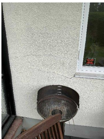
Bild 15: Utvändigt, Fasad, Sprickor, lagningar och lös puts noterades på fasaden
