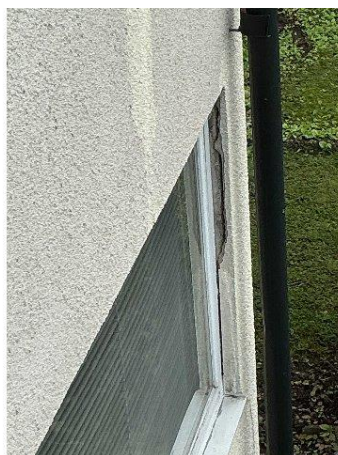
Bild 12: Utvändigt, Fasad, Sprickor, lagningar och lös puts noterades på fasaden
