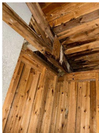
Bild 20: - Utvändigt, Övrigt, Skada i taket noterades Ståndplåt mot hus glipar Sättningar i hörn under grundbalk noterades D...
