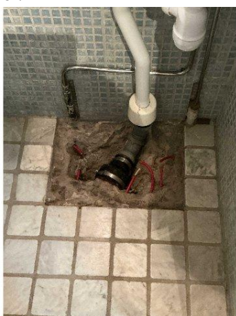
Bild 5: - Invändigt, Entréplan Golvet är uppbilat och värmeslingorna trasiga Det förekommer rörgenomföringar...
