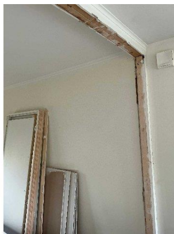
Bild 8: Invändigt, Övervakning, Öppning i vägg ej färdigställd
