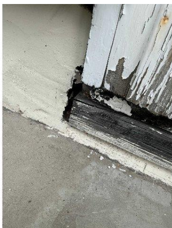
Bild 11: - Utvändigt, Övrigt, Del av räcketts övre del saknas Räcket är rangligt och bör bytas ut det är även för lågt för dage...
