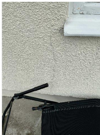
Bild 10: Utvändigt, Fasad, Sprickor, lagningar och lös puts noterades på fasaden
