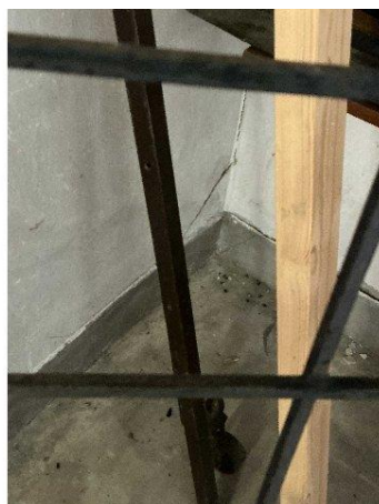
Bild 2: - Invändigt, Entréplan, Spricka i yttervägg .
