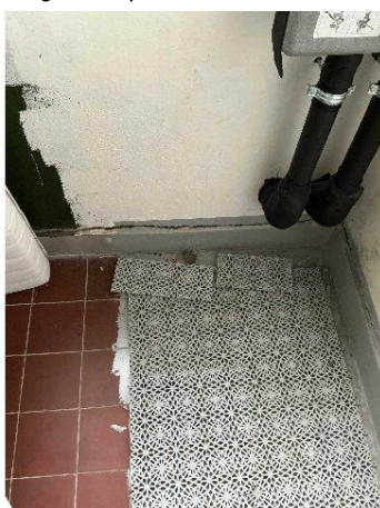
Bild 3: - Invändigt, Entréplan, Spricka i väggens nedre kant Plasttrall utlagd)
