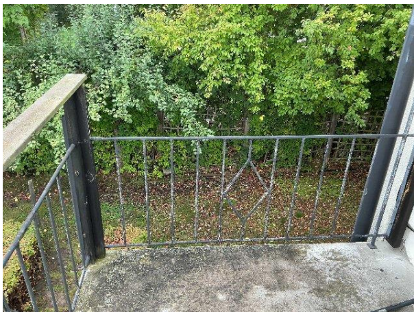
Bild 9: - Utvändigt, Övrigt, Del av räcketts övre del saknas Räcket är rangligt och bör bytas ut det är även för lågt för dagens mått...
