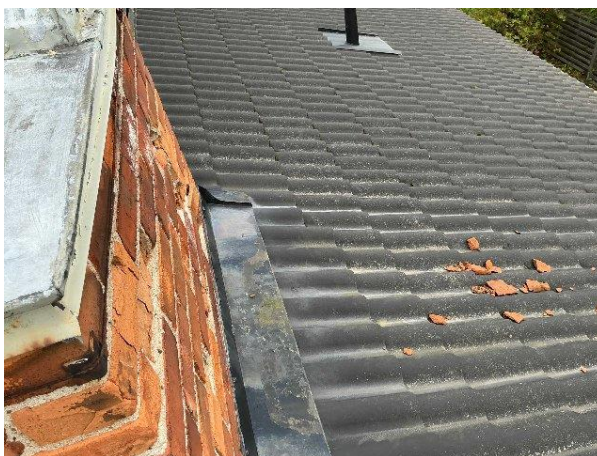
Bild 14: - Utvändigt, Yttertak, Frostsprängd tegel på skorsten Regnskydd saknas på skorsten
