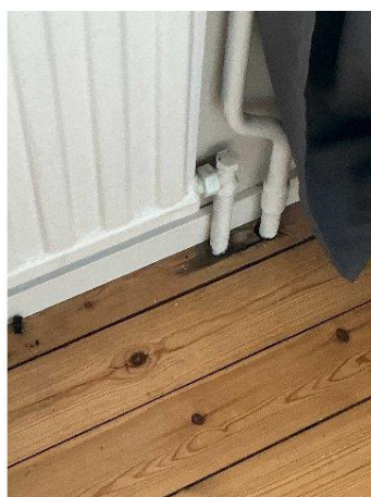
Bild 6: Invändigt, Entréplan, Missfärgning på golv vid radiator
