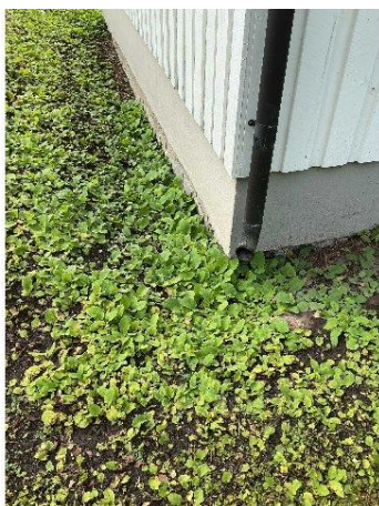
Bild 19: - Utvändigt, Övrigt, Skada i taket noterades Ståndplåt mot hus glipar Sättningar i hörn under grundbalk noterades D...
