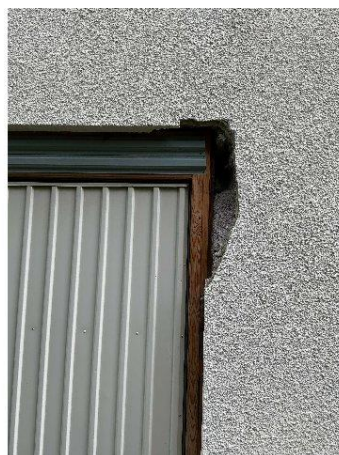
Bild 16: Utvändigt, Fasad, Sprickor, lagningar och lös puts noterades på fasaden
