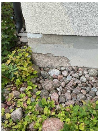
Bild 13: - Utvändigt, Grundmur/Hussockel, Lös puts på sockel Delvis är hussockeln dold av trall
