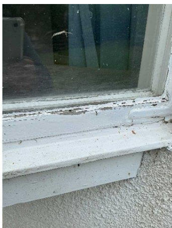
Bild 17: Utvändigt, Fönster, Färg och kittsläpp noterades på fönster
