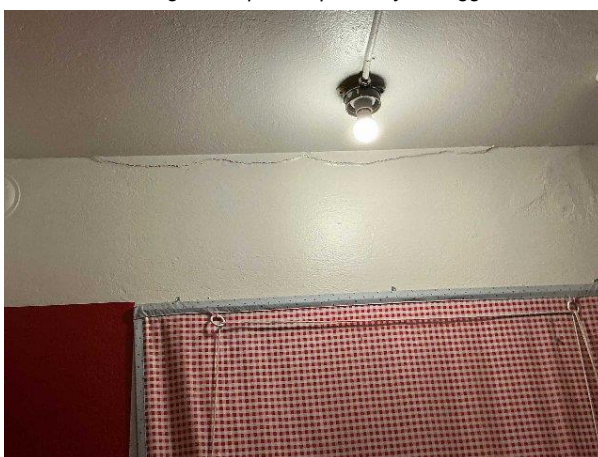
Bild 4: - Invändigt, Entréplan, Sprickor i vägg
