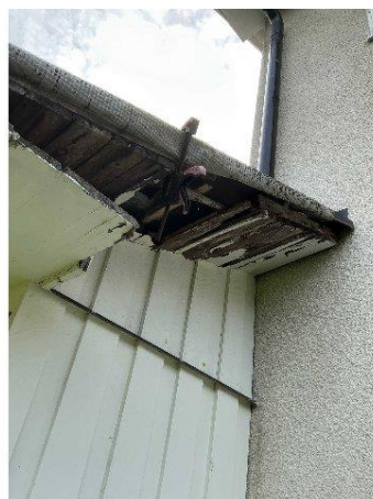
Bild 18: - Utvändigt, Övrigt, Skada i taket noterades. Ståndplåt mot hus glipar. Sättningar i hörn under grundbalk noterades. D...
